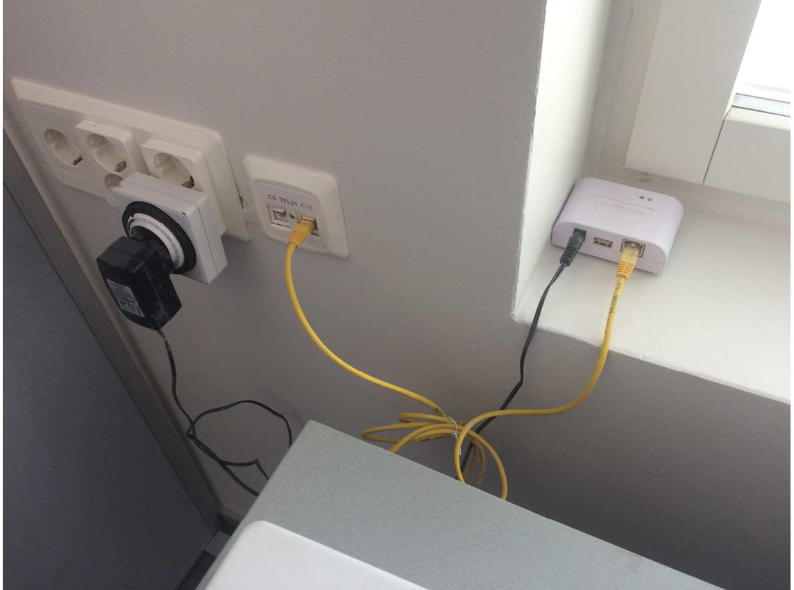
Kuva 34. RFSensIT Oy:n tukiasema valmiissa rakennuksessa.
