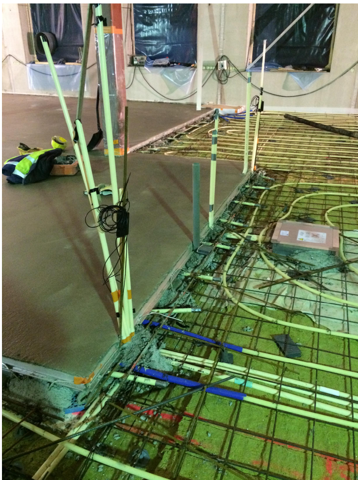
Kuva 38. Koerakenteen valupäivä. Kuvassa on liikuntasauaman tekemä mutka, jonka keskeltä nousee villarakenteen kokoojaurasta tuuletusputki. Vertailurakenteen valu on tehty jo edellisenä päivänä.
