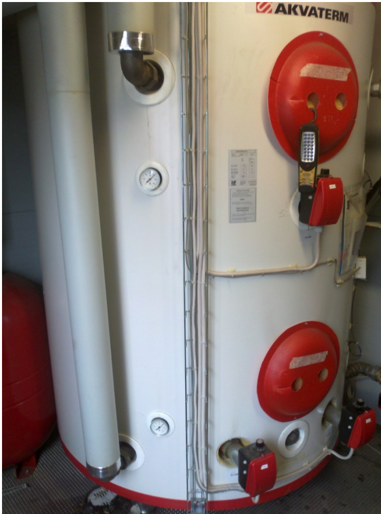
Kuvio 4. Vähäkankaan lämpölaitoksen lämminvesivaraaja. (Harri Mannela 2015)
