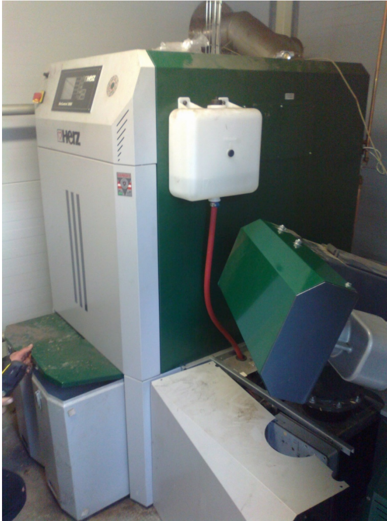
Kuvio 3. Vähäkankaan lämpölaitoksen kattila. (Harri Mannela 2015)
