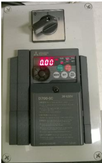
KUVIO 15. Kuva leukamurskaimeen asennetusta taajuusmuuntajasta (Kuva: Timo Hietalahti 2015)
