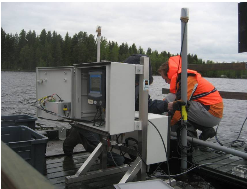
Kuva 22. Dataloggeri on auki olevan kaapin ovessa. Kuva: Laura Karhu
