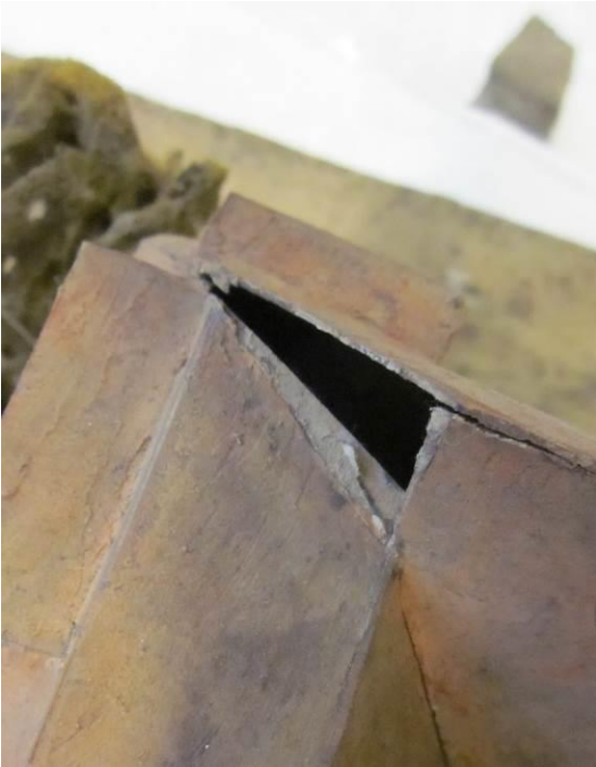
Kuva 26: Puuttuva kattolape (HSch)
