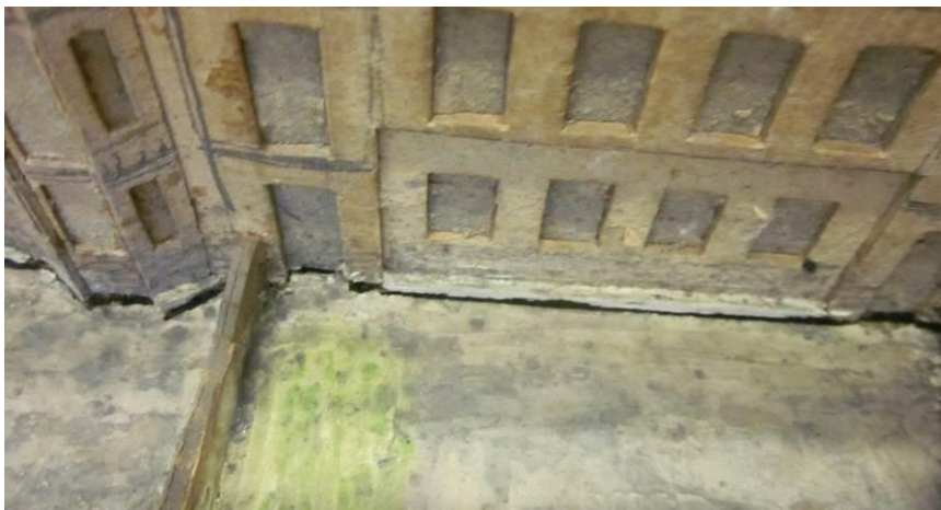
Kuva 29: Pohjasta irrallaan olevat julkisivut (HSch)
