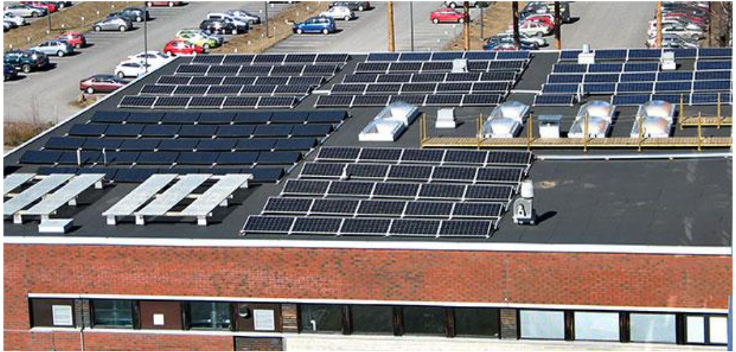
KUVA 2. Lappeenrannan teknillisen yliopiston tasakattovoimala (LUT 2014).
