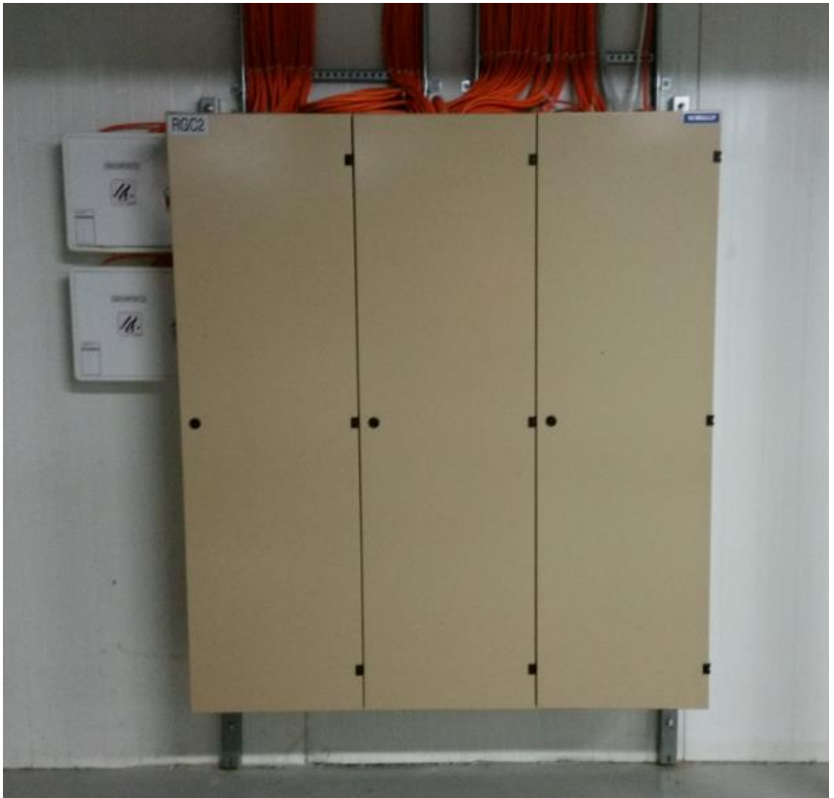
KUVIO 12. Einestehtaan savunpoistojärjestelmän ohjauskeskus.
