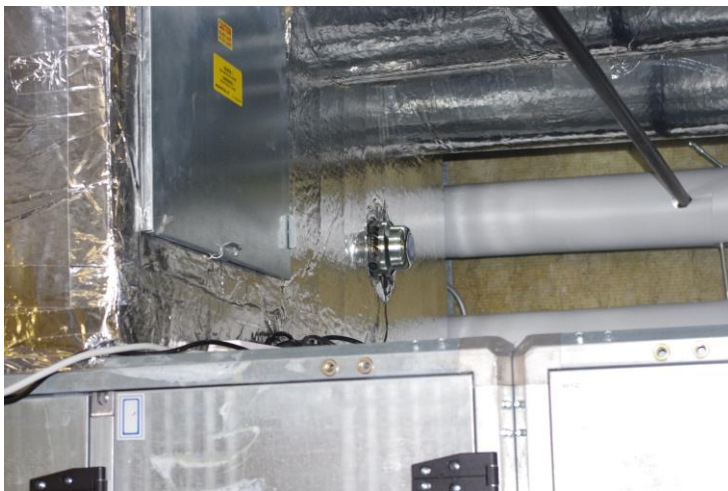
Kuva 6: Toinen sairaalan ilmastointikoneen REME-kennoista
