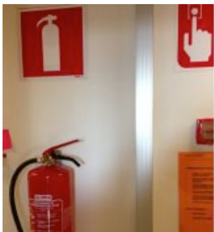
Kuva 21: Asiantuntijan on helppo huomata, että opasteet eivät palvele tarkoitustaan, mikäli ne ovat käytän seinässä esim. sammuttimen kohdalla.
