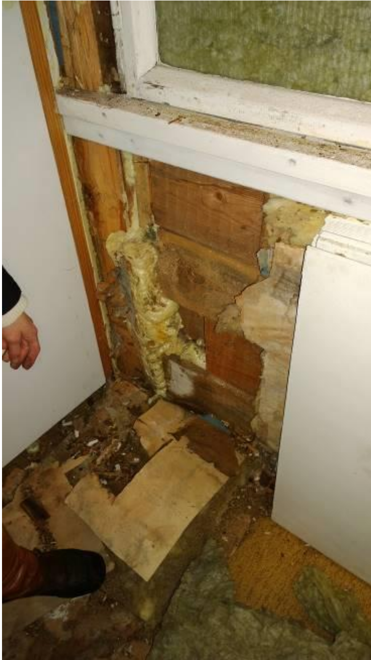
Kuvio 7 Rakenneavaus vauriokohdasta
