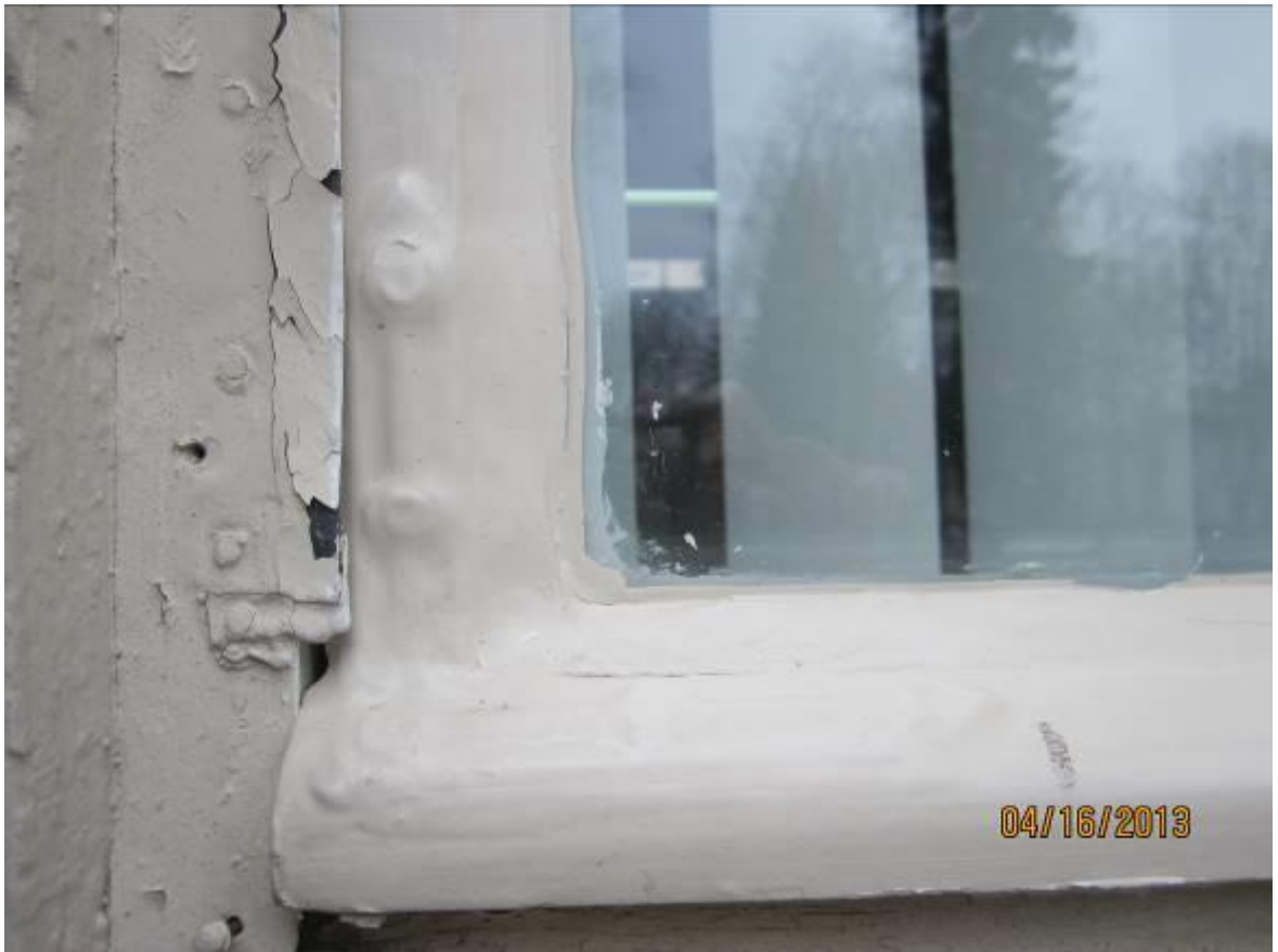
Kuvio 16 Nykyaikaisin materiaalein kunnostettu ikkuna.
