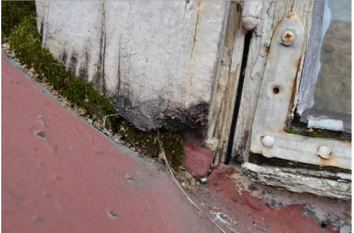
Kuvio 8 Vahtimestarin asunnon itäseinän vaurio
