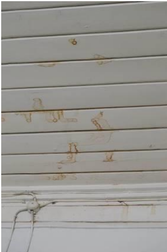
Kuvio 10. Vesivaurioita vanhan vahtimestarin asunnon alapuoleisessa huoneessa.
