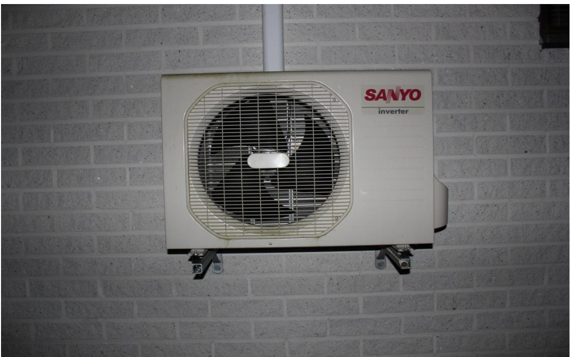
Kuvio 4. Ilmalämpöpumpun ulkoyksikkö.
