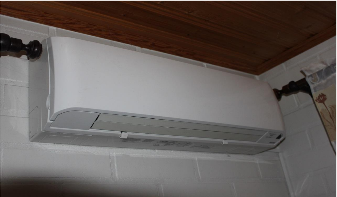
Kuvio 3. Ilmalämpöpumpun sisäyksikkö.
