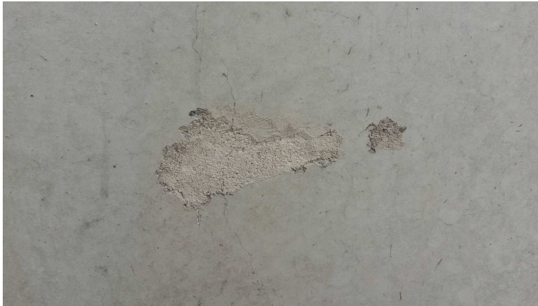
KUVIO 18. Julkisivurakenteen pinnassa näkyvä laastipaikkaus.
