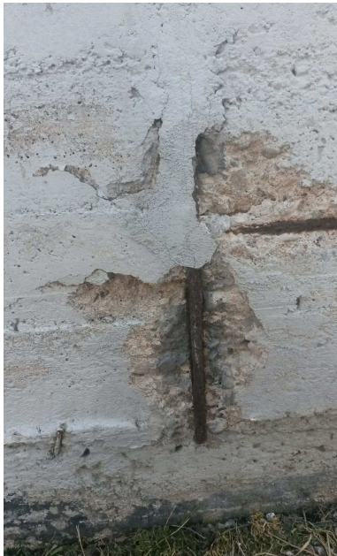
KUVIO 12. Rapautuneen betonin alta näkyvä korroosiosta kärsivä raudoite.
