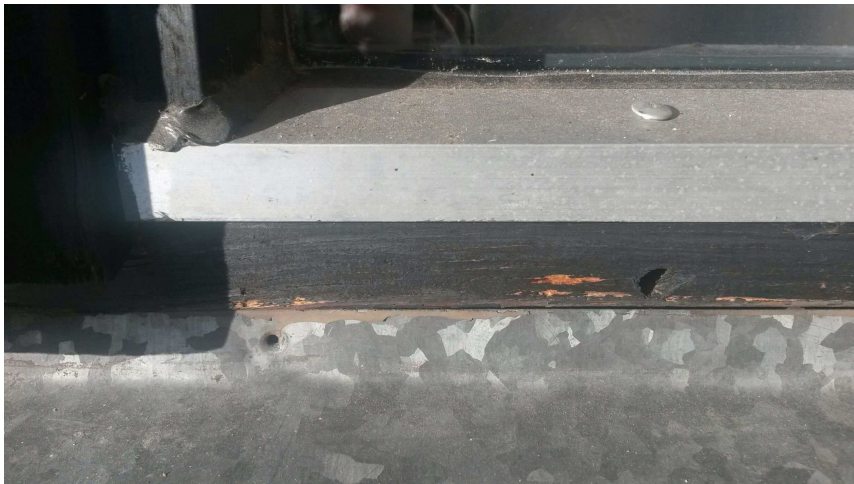
KUVIO 15. Ikkunan ulkokarmissa auringon säteilyn vaikutuksesta alkanutta pintakäsittelyn vaurioitumista.
