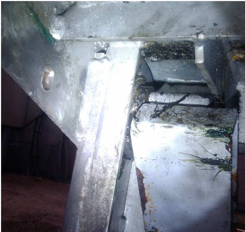
KUVA 3, Hankauksesta aiheutunut kolo levyssä
