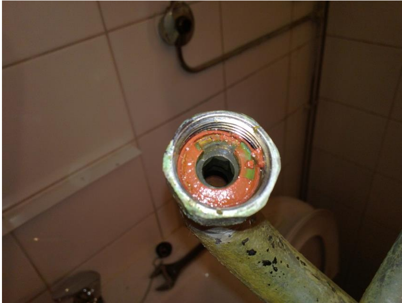
Kuva 9. Pyyhekuivaimen vuodon aiheuttanut vaurioitunut tiiviste.
