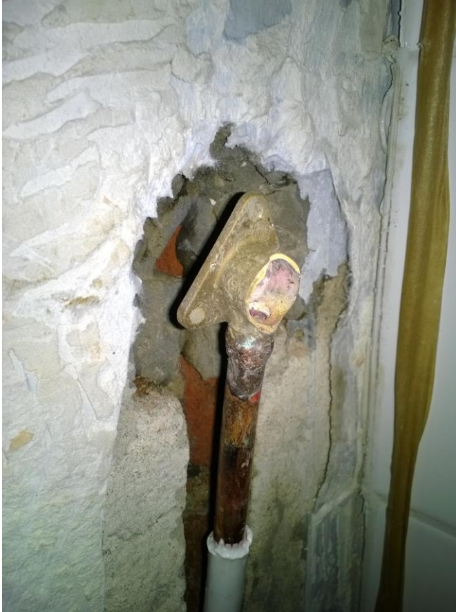
Kuva 12. Haljennut hanakulma, josta vuoto aiheutui.
