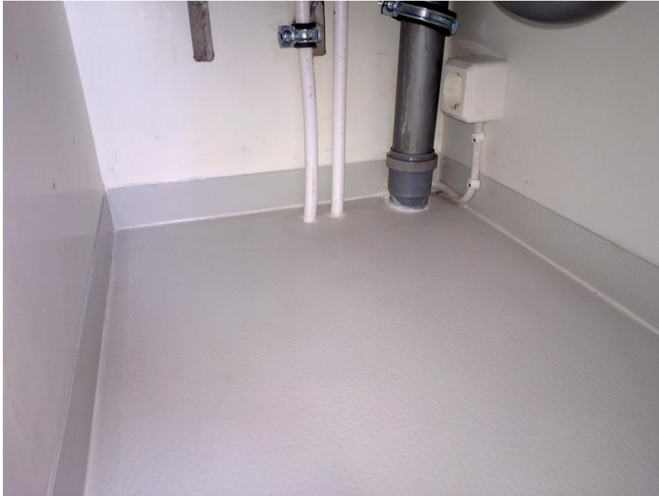
Kuva 1. Putkiremontin yhteydessä asennettu vuotokaukalo keittiön alakaapissa.
