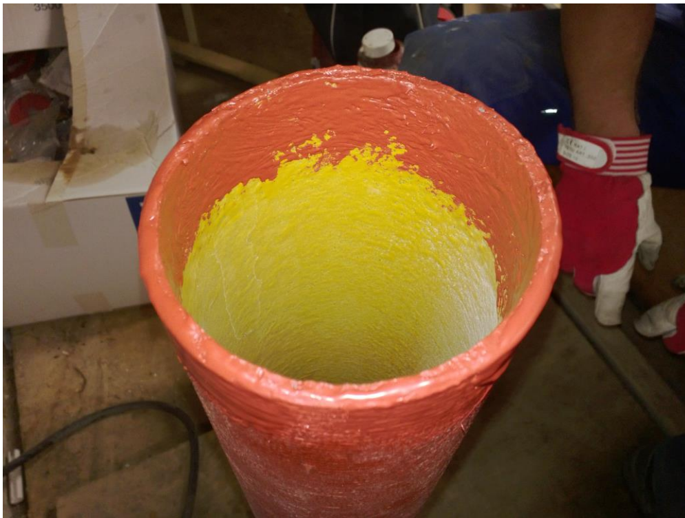
Kuva 8. Lämpimältä 100 mm leikatun valurautaviemäriin maalattu pää.
