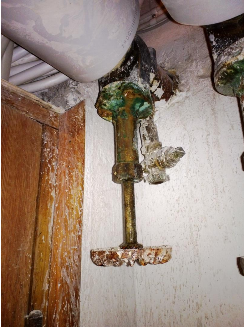
Kuva 4. Vanha sulkuventtiili lämpöjohtoverkostossa.
