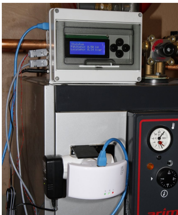
Kuva 14. Mittauslaitteisto paikoillaan lämmityskattilan päällä. Kuvan alalaidassa näkyy WLAN-reititin.
