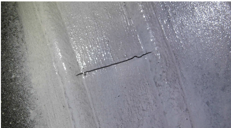
Kuva 2. Magneettijauheella löytynyt särö savukaasupuhaltimen siipipyörässä.
