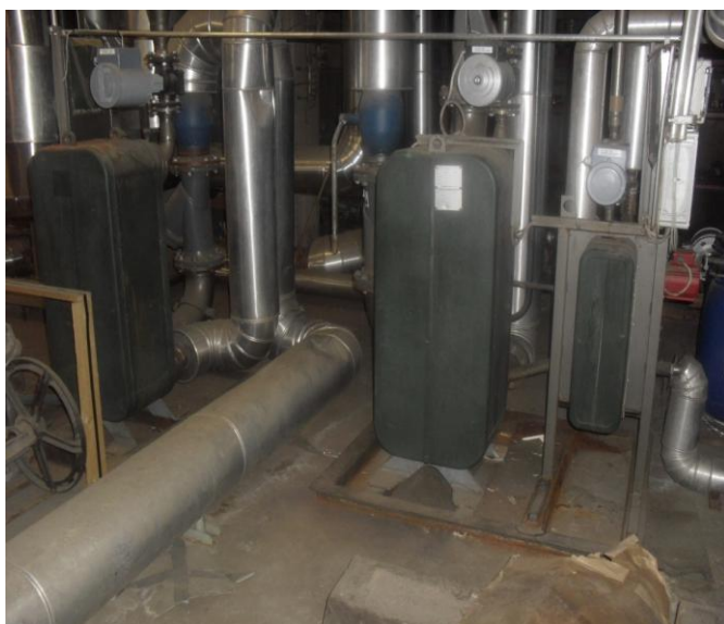
Kuva 4.1.1. Voimalaitoksen 5. kerroksen RT-, R- ja lämpimän käyttöveden lämmönsiirrin (Olli-Pekka Vanhala)
