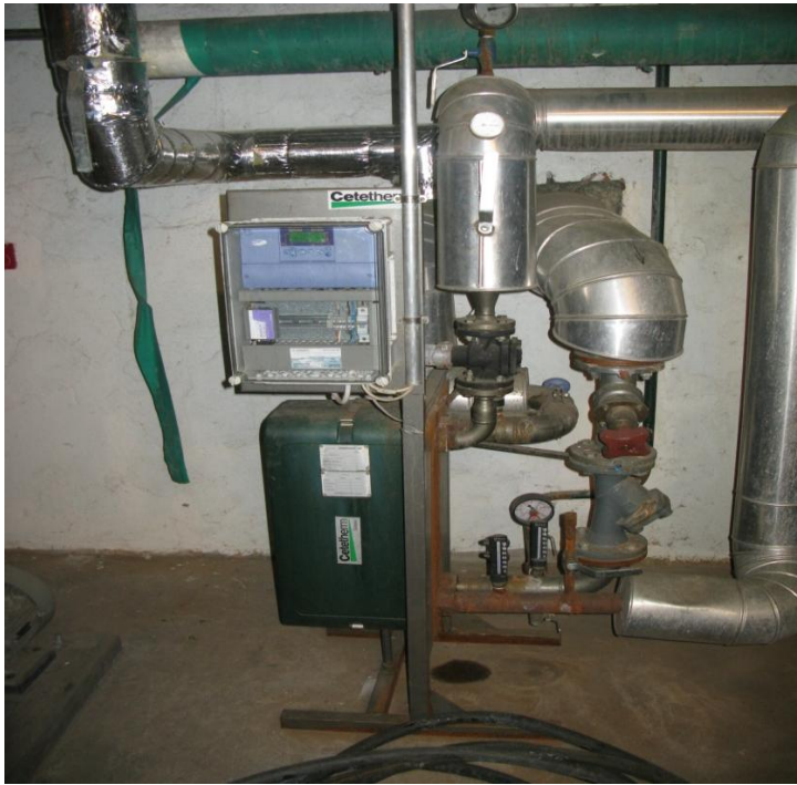
Kuva 4.1.2. Voimalaitoksen 1. kerroksen kiinteistölämmönsiirrin (Olli-Pekka Vanhala)
