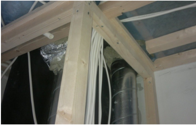
Kuva 24. Puutteellinen putkikanaalin tiivistys
