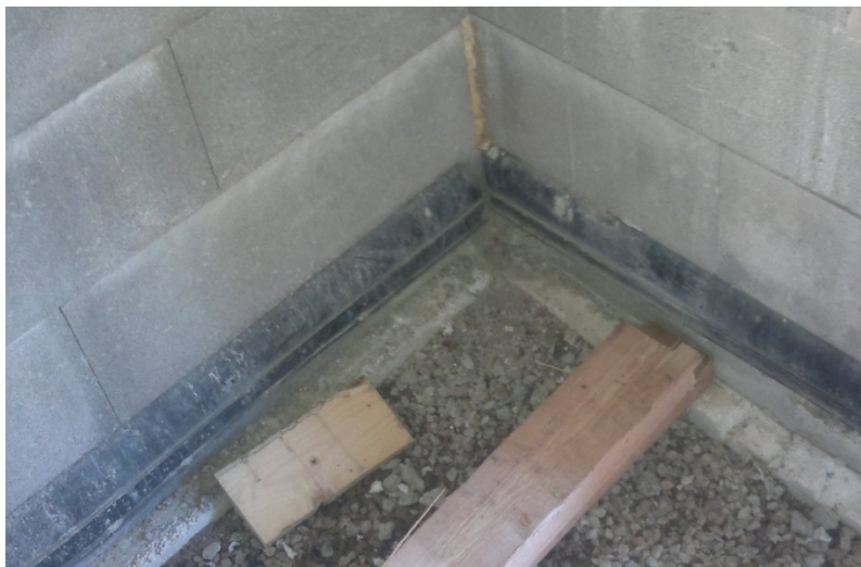
Kuva 30. Ilmansulku- ja radonkaistan puutteellinen asennus.
