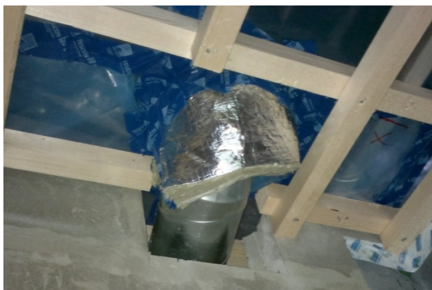
Kuva 23. Höyrynsulkumuovi tiivistetty virheellisesti iv-kanavan eristykseen
