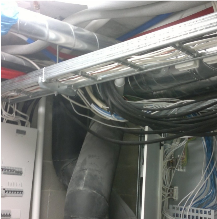
Kuva 26. Teknisen tilan tiivistysongelma. Teknisen tilan ja asuintilan välisiä läpiviennitejä ei ole mahdollista enää tässä vaiheessa tiivistää ilmatiiviisti.
