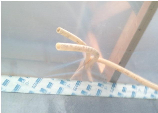
Kuva 21. Sähköputkien rikkoma höyrynsulkumuovi.
