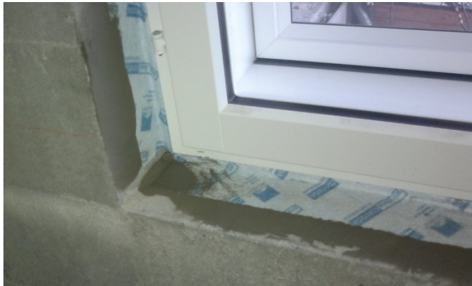
Kuva 20. Contega FC tiivistysnauhan virheellinen asennus. Laskos puuttuu.
