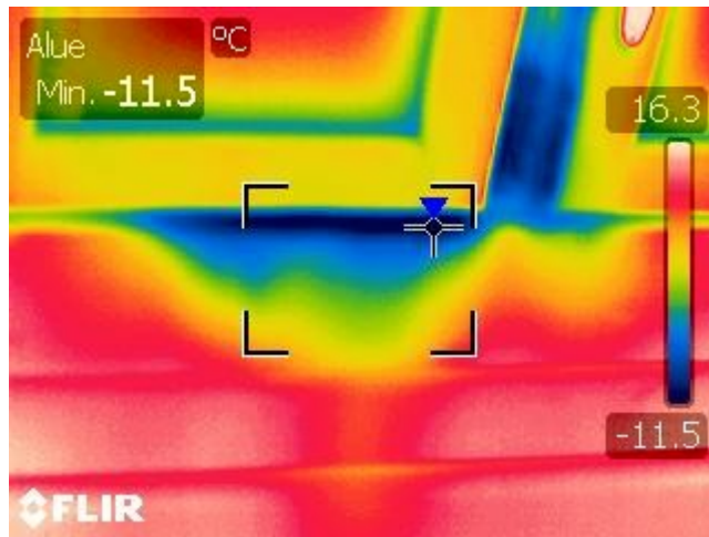
Kuva 14. Esimerkkikuva huonolaatuisista ikkunoista. (Nurmi, 2012)
