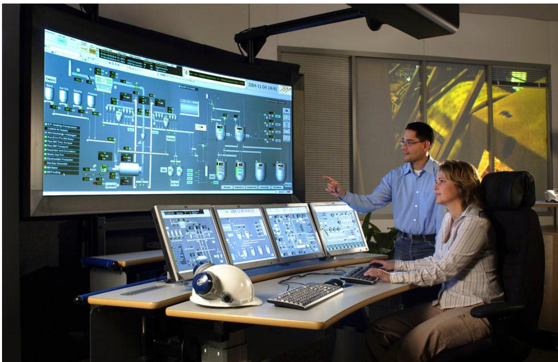
Kuva 18. Nykyaikainen ison betoniaseman valvonta/ohjaushuone. [11]
