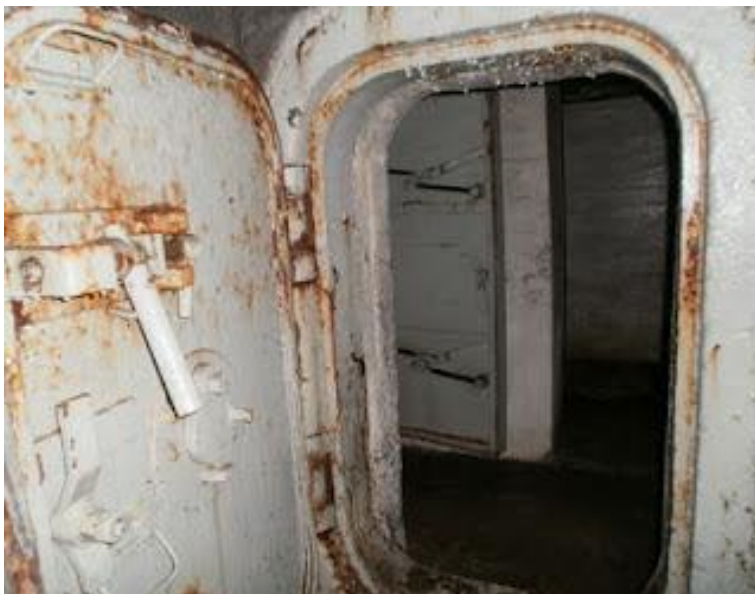
Kuva 36: Bunkkerin oviaukko, maalikorjausta vailla,( internet – kuvahaku)
