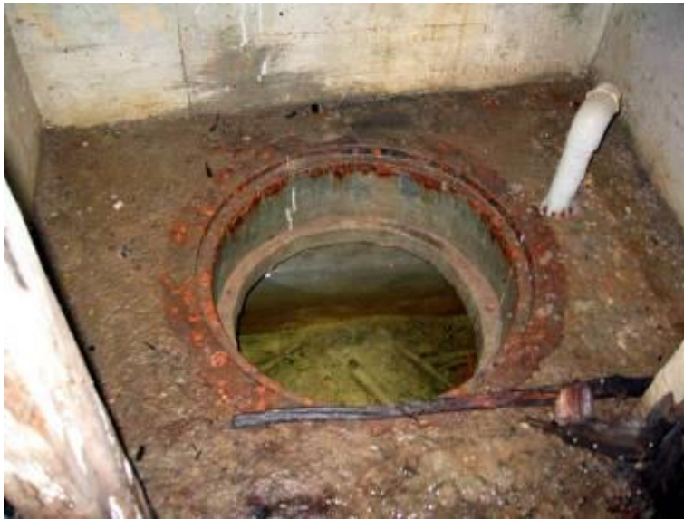
Kuva 35: Bunkkerin kaivo, kosteusongelmia,(internet- kuvahaku)
