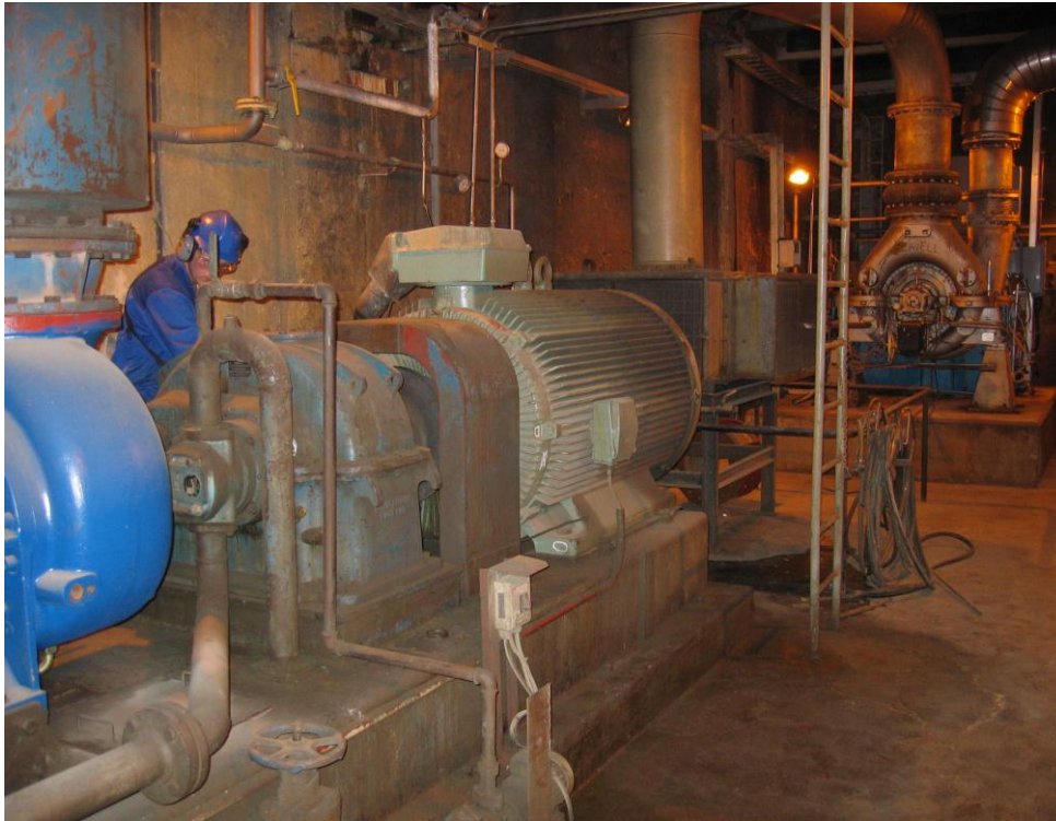
Kuva 8. Varakompressorin 983.06 kokonaisvärähtelytason mittaus. Taustalla on ABB:n mittauksen suorittaja Sami Peltonen. Taustalla näkyy myös kompressorin 983.07.
