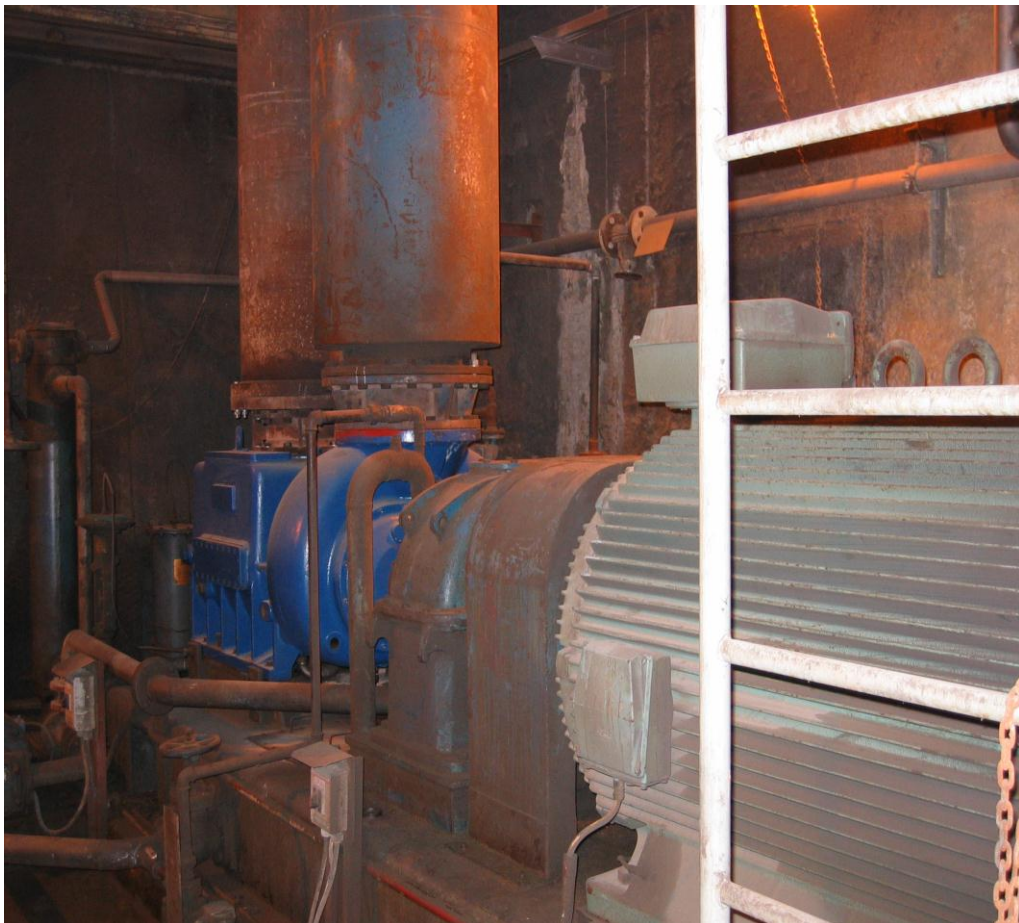
Kuva 7. Kompressorit 983.06 joka, toimii varakompressorina.
