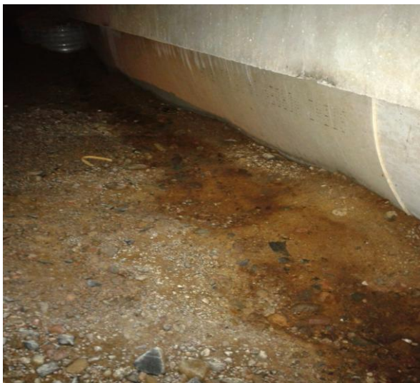
Kuva 2 280/01 Reunapalkki, maassa merkkejä kosteudesta.
