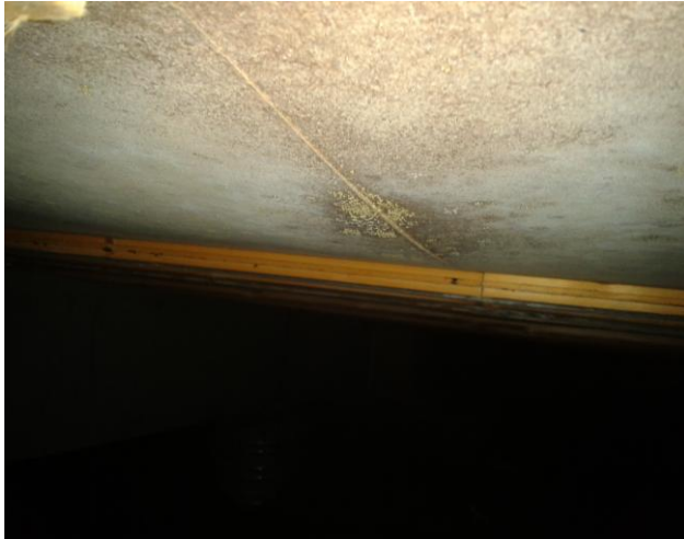
Kuva 3 280/01 Alapohjassa merkkejä tiivistyneestä kosteudesta.
