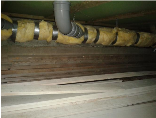
Kuva 8 322/00 levyt kupruilla, kosteusjälkiä.
