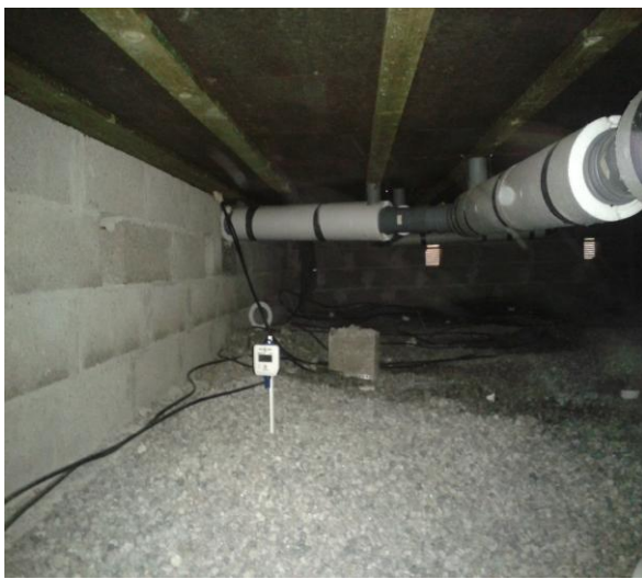
Kuva 4 630/08 Anturi sijoitettuna kantavan keskilinjan viereen.
