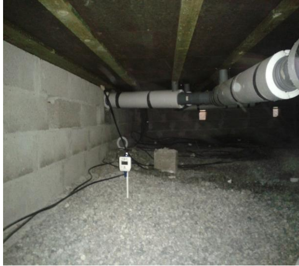
Kuva 4 630/08 Anturi sijoitettuna kantavan keskilinjan viereen.
