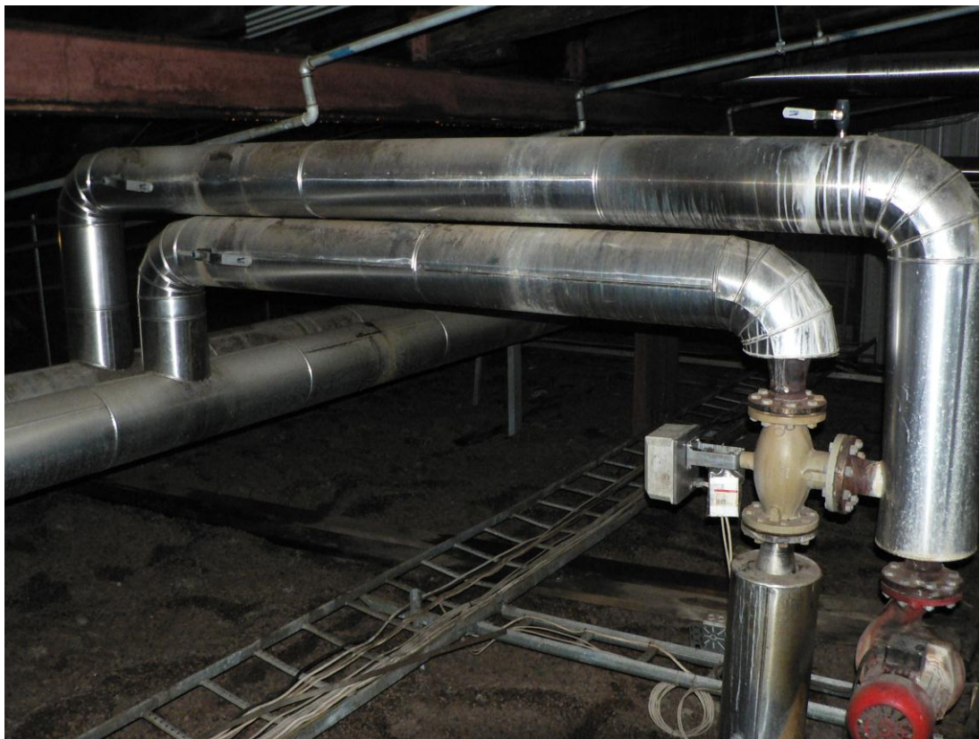
Kuva 6. Kiertovesiverkoston kanavakuivaamon vintillä (Kuva: Kari Luotonen, 2012)
