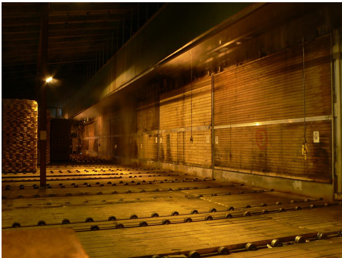
Kuva 8. Kanavakuivaamon kuormansiirtotekniikka (Kuva: Kari Luotonen, 2012)
