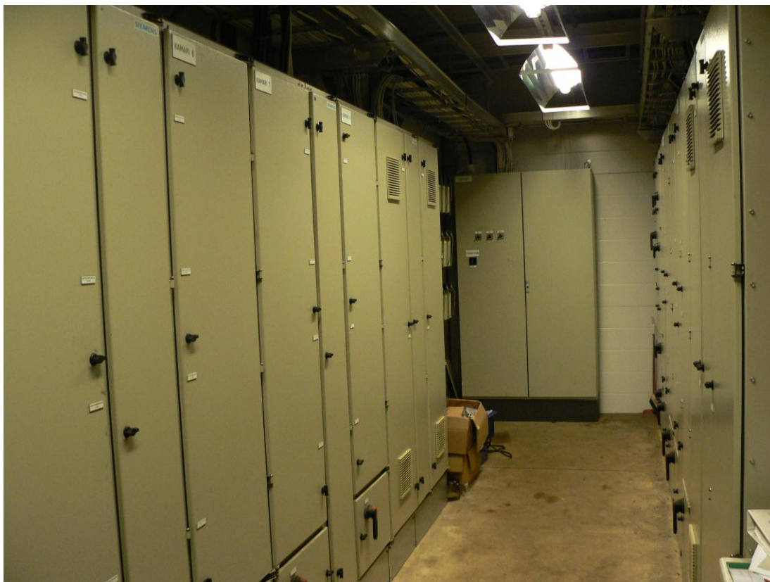
Kuva 11. Kamarikuivaamon sähkökeskus. (Kuva: Kari Luotonen, 2012)
