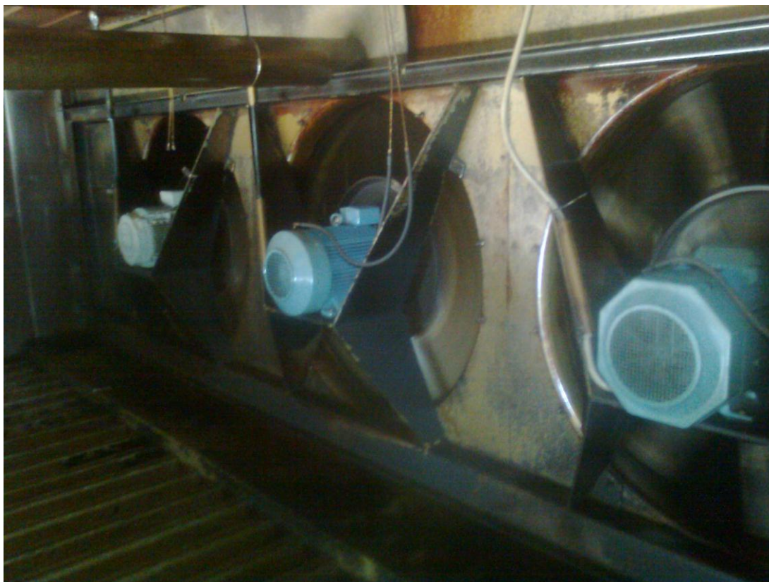
Kuva 7. Kamarikuivaamon kiertoilmapuhaltimia (Kuva: Kari Luotonen, 2012)
