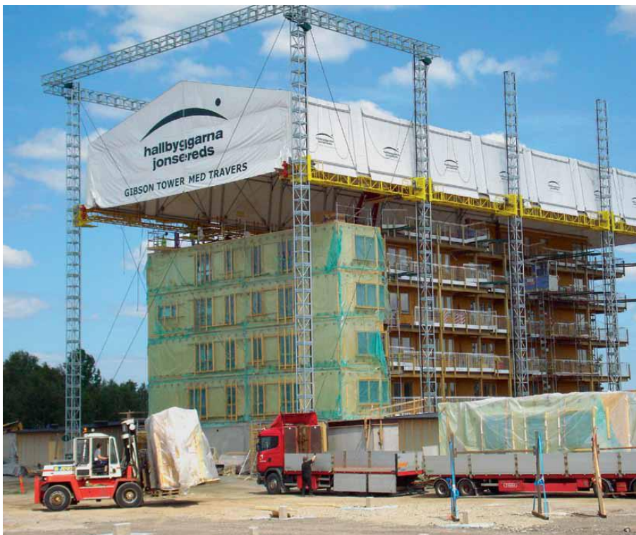
Kuva 6. Nouseva sääsuojaratkaisu. Kate nousee ja laskee sähkötoimisten moottoreiden avulla. Gibson Tower, Lainapeite Oy /15/.
