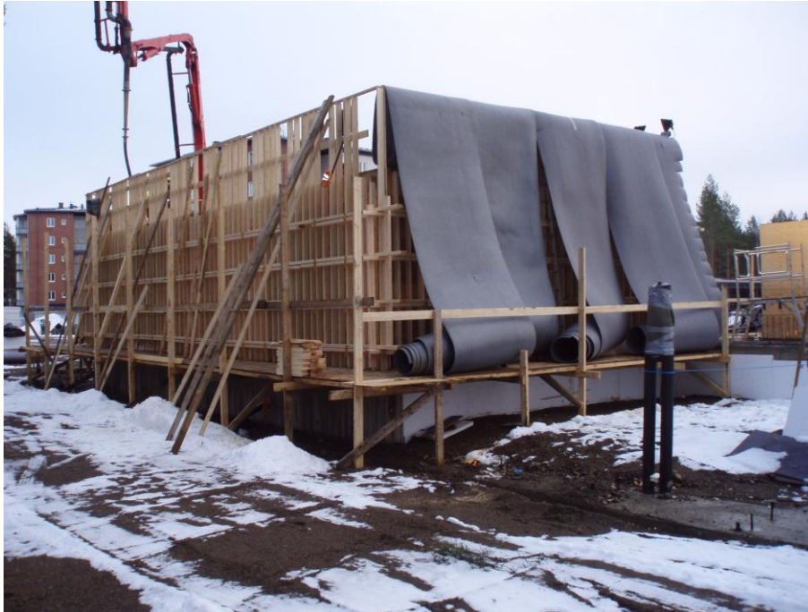
Kuva 10. Väestönsuojan betonivalut. Holvin reunalla näkyy solumuoviset pakkasmatot valmiina betonivalun suojausta ja lämmöneristämistä varten. Pakkasmattojen päälle levitettiin lisäksi kevytpeitteet.
