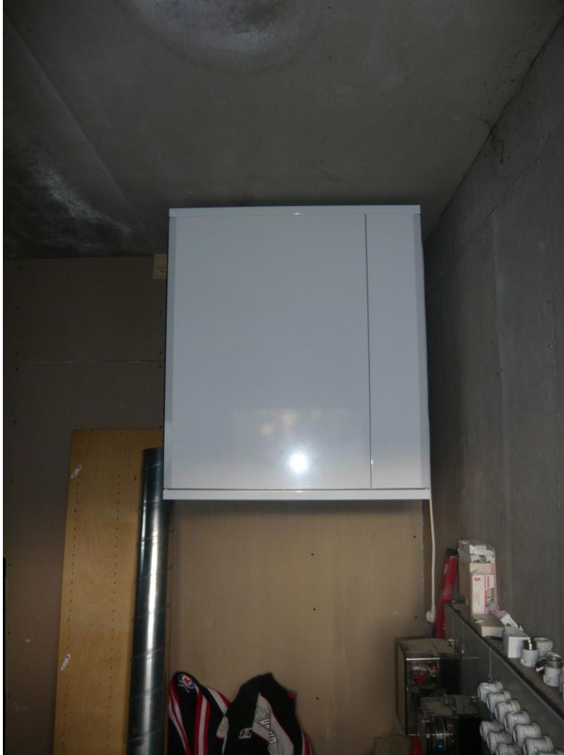
Kuva 14. Ilmanvaihtokone pyörivällä lämmönsiirtimellä.
