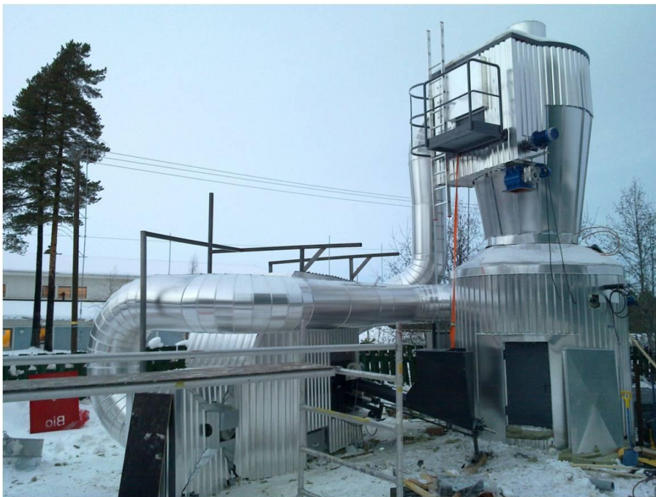
KUVIO 7. Kuivuriosa ja kattila. Kuvassa on näkyvillä myös kuivauskaasun siirtoputket. (CCM-Power.)
