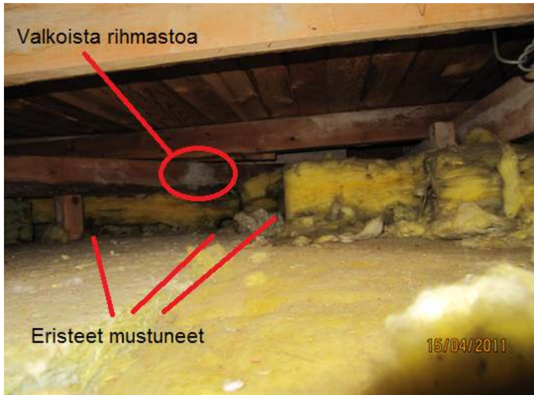
Kuva 24. Yläpohjan puutteellisesta tuuleuksesta johtuvia ongelmia
