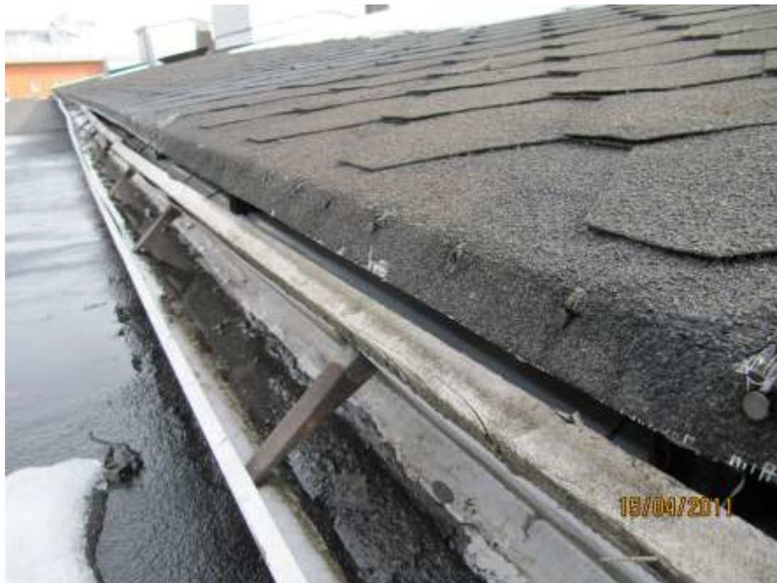
Kuva 31. Rästyslauta kouruineen, ja huopa on irronnut räystäältä
