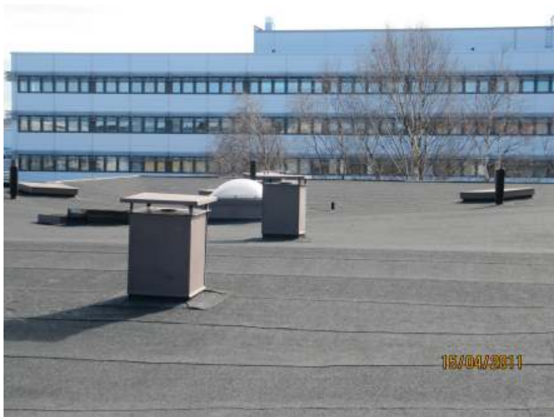
Kuva 23. Yläpohjan tuuletusputkia ei ole
