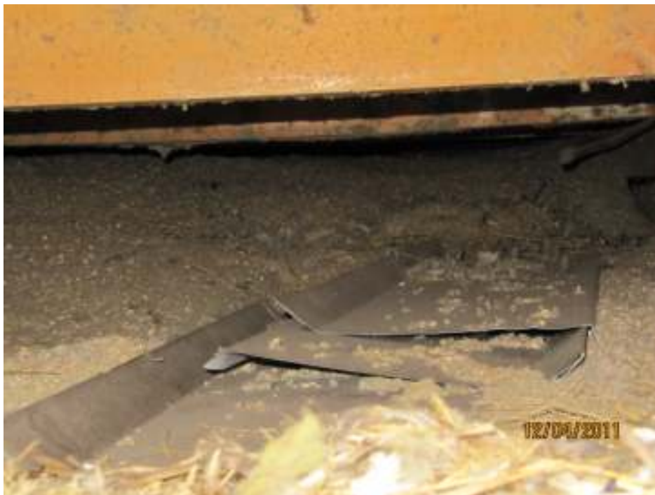
Kuva 14. Epätasaisesti asennettu puhallusvilla estää tuuletuksen toiminnan
