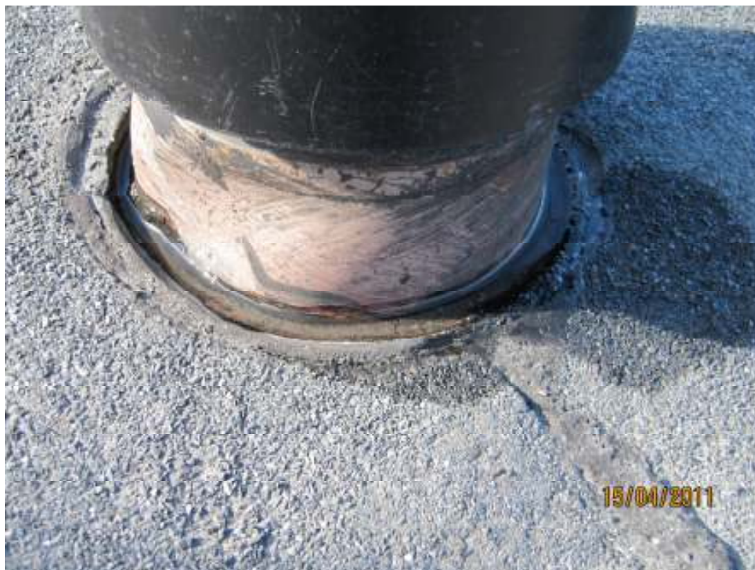
Kuva 20. Läpiviennistä puuttuu kaulus ja läpiviennin juureen kertyy vettä
