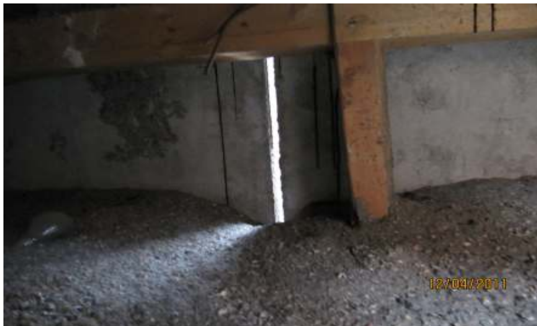
Kuva 16. Betoniseinässä olevasta raosta varisee eristettä ulos
