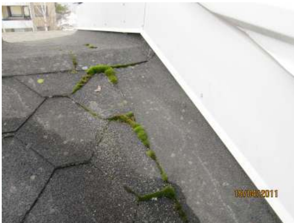
Kuva 26. Vesikate on osittain sammaloitunut
