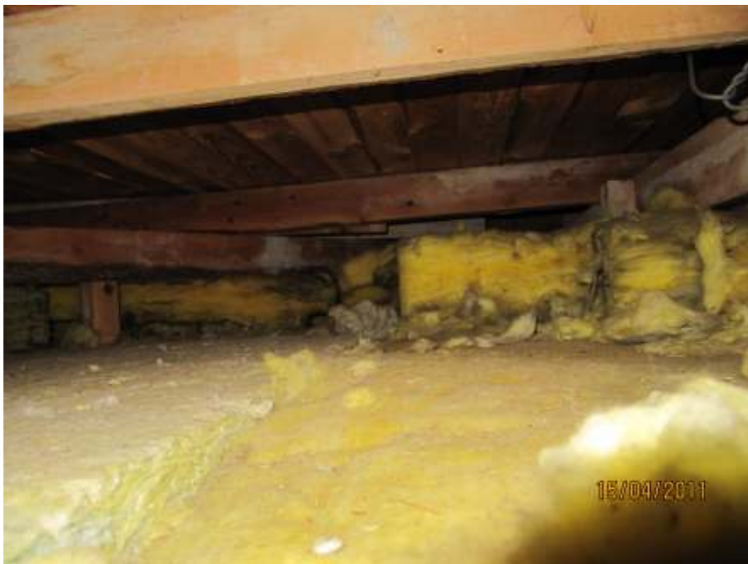
Kuva 3. Yläpohjan puutteellisesta tuuleuksesta johtuvia ongelmia
