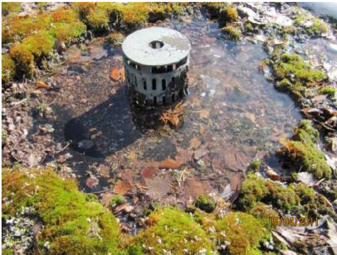
Kuva 37. Kattokaivot eivät vedä
