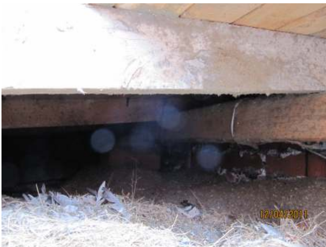
Kuva 15. Yläpohjan tuuletusaukoista oli päässyt lintuja pesimään ryömintätilaan
