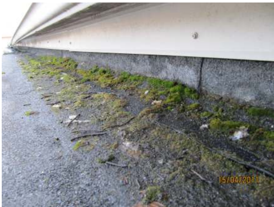
Kuva 30. Parvekkeen katto on sammaloitunut seinän vierestä
