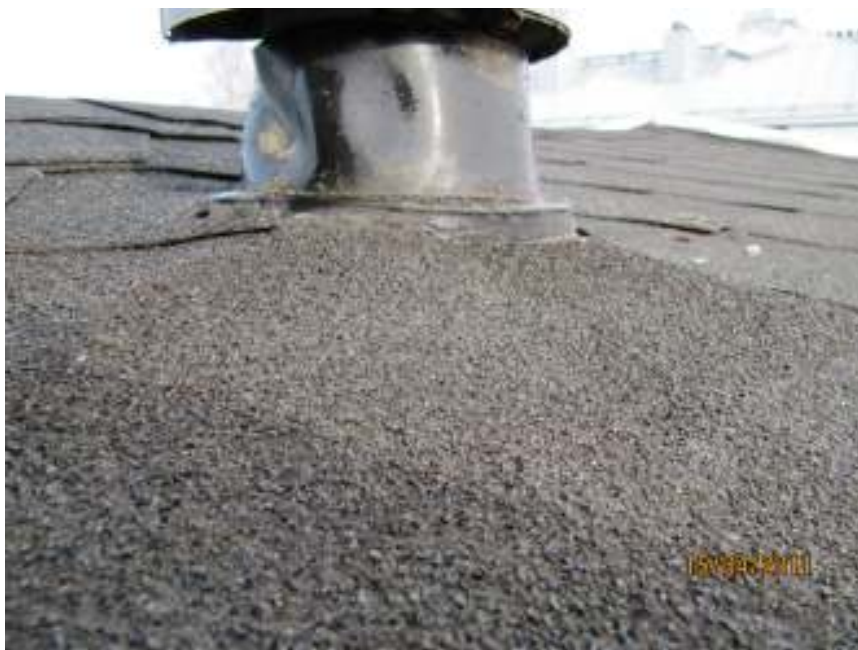
Kuva 33. Vesikate on irronnut läpiviennin ympäriltä
