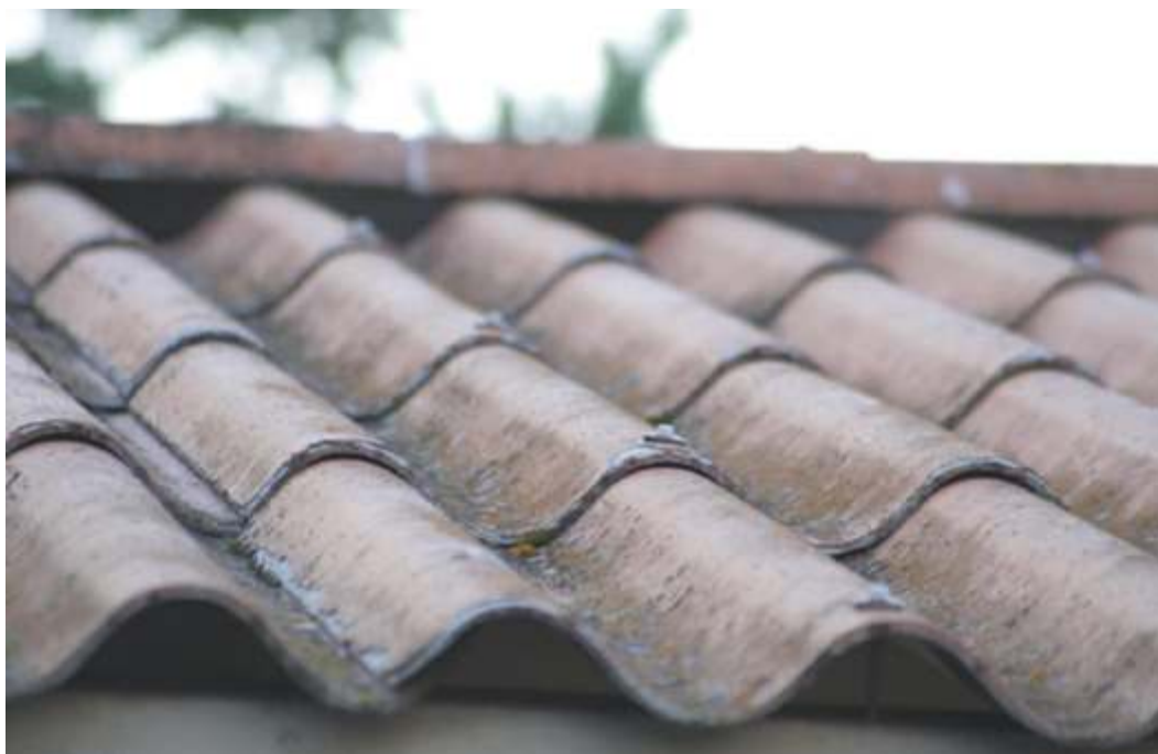
Kuva 8. Hoitamatta jäänyt kuitusementtilevykate on sammaloitunut ja kulunut
