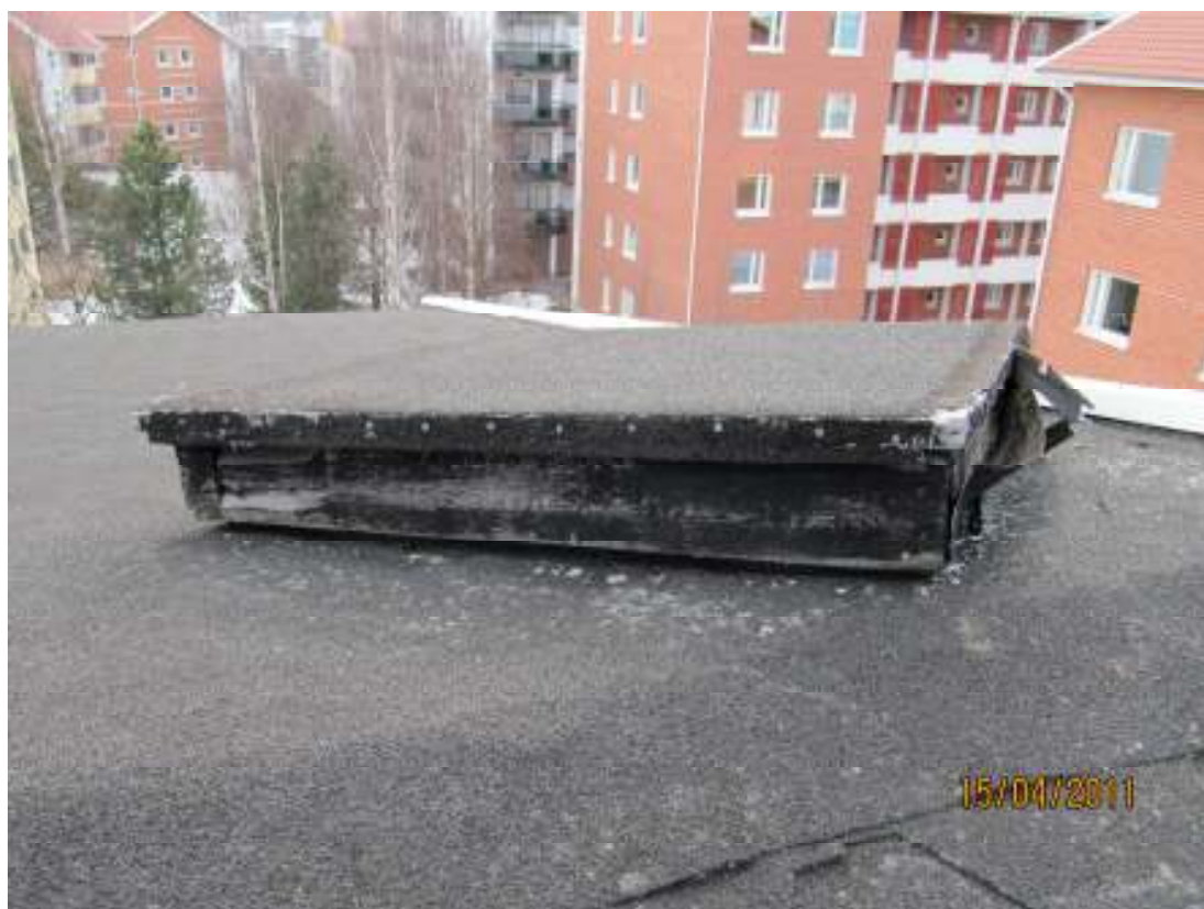
Kuva 28. Kaikki tarkastusluukut ovat huonokuntoisia
