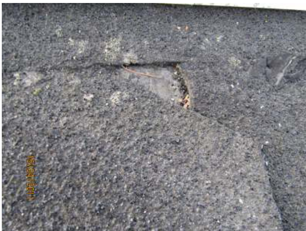
Kuva 27. Vesikatteessa on reikiä
