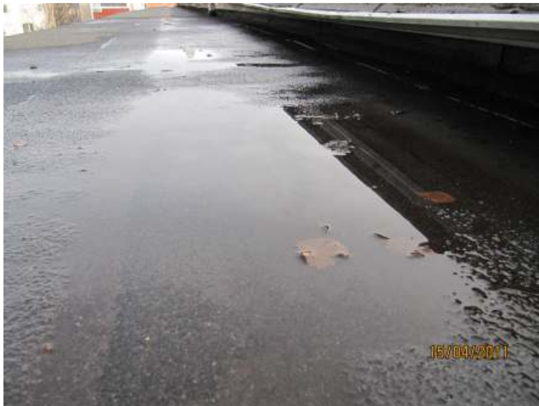
Kuva 29. Vesi asuu parvekkeiden katoilla
