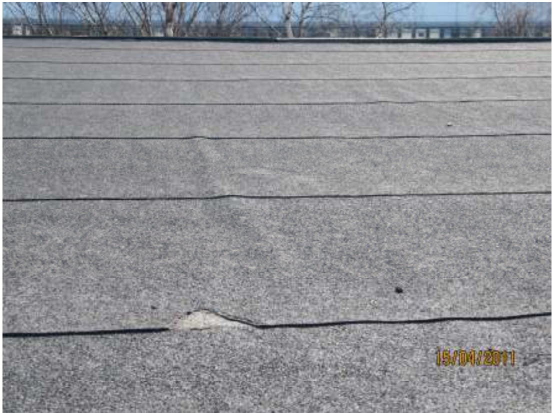
Kuva 19. Saumoista katteen alle päässyt kosteus on aiheuttanut katteen irtoamista
