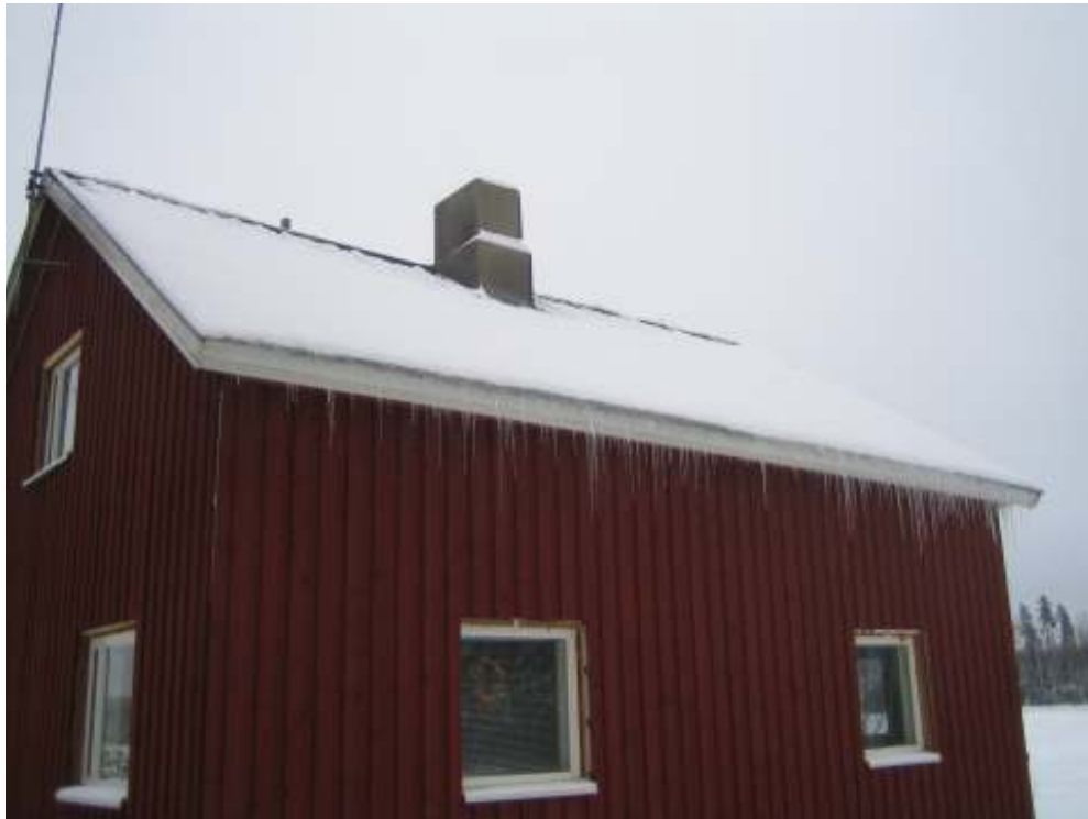
Kuva 2. Yläpohjan lämpövuoto näkyy jääpuikkoina räystäällä
