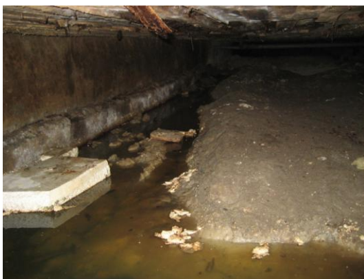
Kuvio 28. Ulkoseinän anturan viereen kerääntynyttä vettä.
