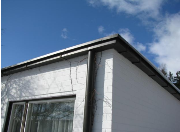
Kuvio 31. Sadevesikouru ja syöksyputki.
