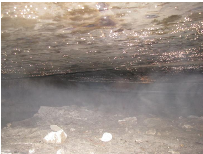
Kuvio 24. Valuvaiheessa vaurioitunut alapohjalaatta.
