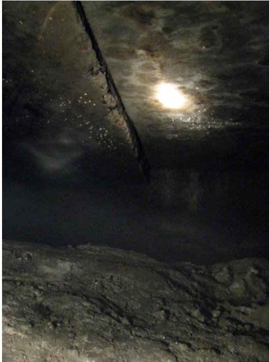
Kuvio 25. Valuvaiheessa vaurioitunut alapohjalaatta.
