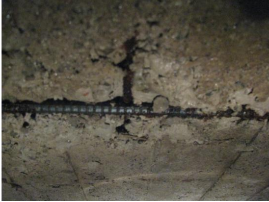
Kuvio 23. Raudoitusta näkyvässä alapohjalaatan alapinnassa.
