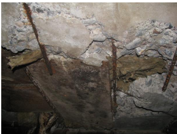
Kuvio 26. Vaurioitunutta alapohjalaattaa.
