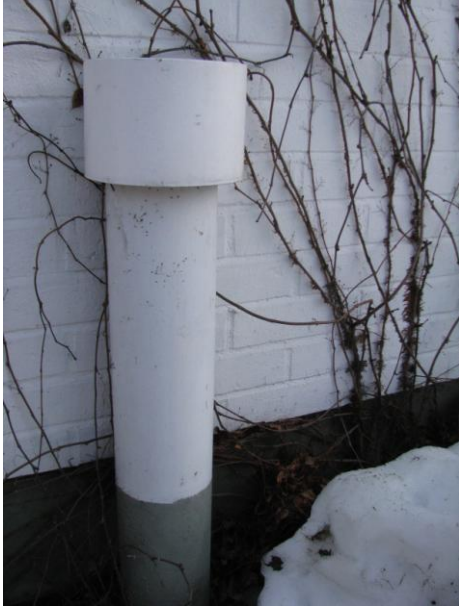
Kuvio 33. Sokkelin tuuletusputken yläpää.
