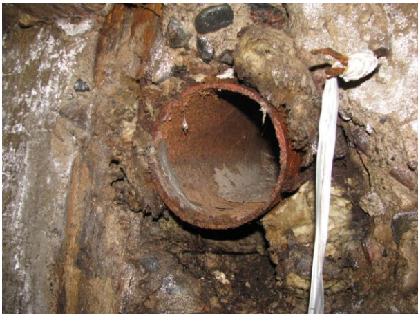
Kuvio 34. Sokkelin tuuletusputken alapää.
