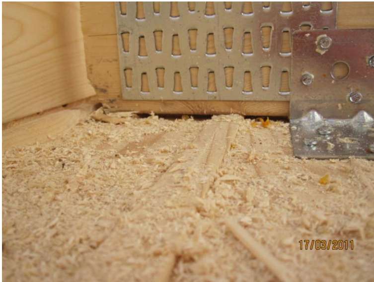
Kuva 5. Kattoristikon leimapaineen ylittyminen.
