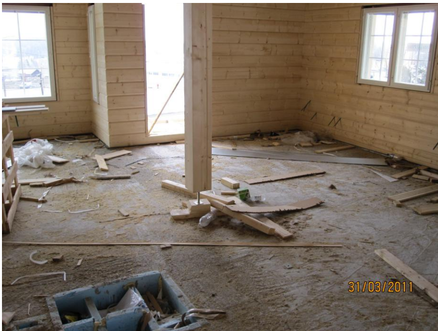
Kuva 3. Putoamissuojauksen puuttuminen oviaukosta.
