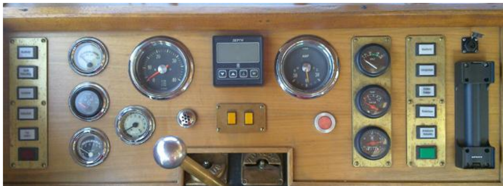
Kuva 10. Veneen alaohjaamon ohjauspulpetti ennen laitteiston asennusta. Kuvan oikeassa reunassa näkyvä radiopuhelimen teline siirrettiin ohjainsauvan ja merkkivalojen tieltä pois.
