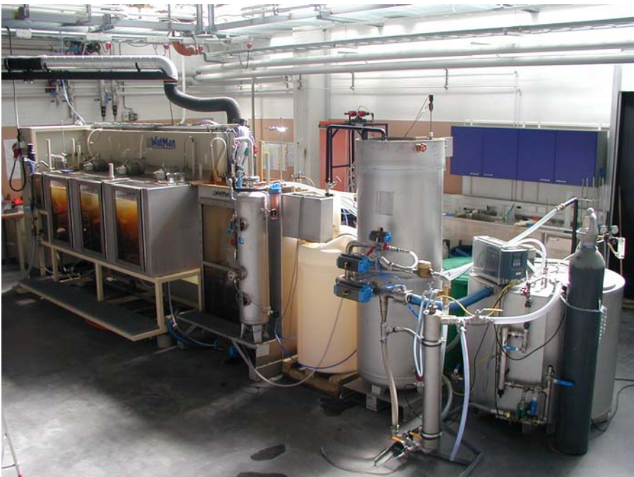
Kuva 2. Savonia-amk:n vesilaboratorion vesilaitospilotti (kuva: Teija Rantala)
