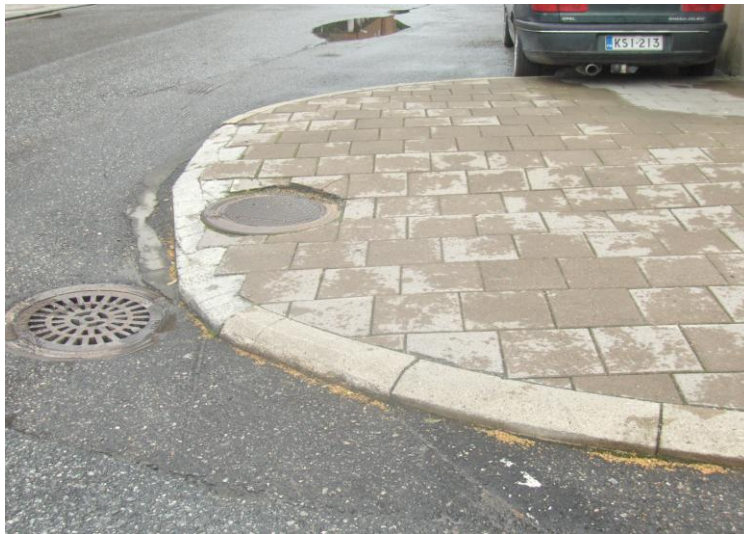
Kuva 6. Katujen reunakivetykset haittaavat rollaattorilla kulkemista.
