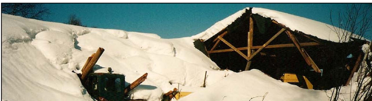
Kuva L33. Lumen paino romahdutti liiterin 1990-luvun alkupuolella, jonka seurauksena rakennus purettiin kokonaan. Kattorakenteet ovat hyvin näkyvissä tässä kuvassa (Karhu 2010).
