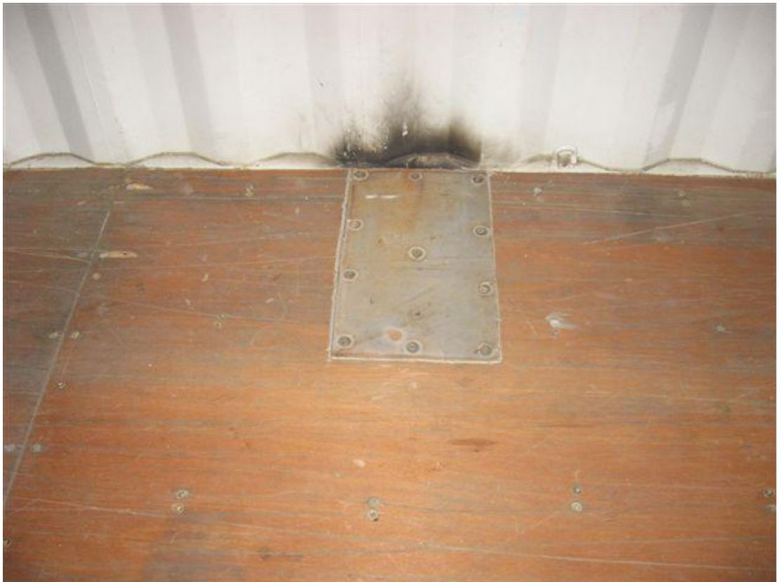
(Kuva 5. Lattia korjattu väärin metallipaikalla)
