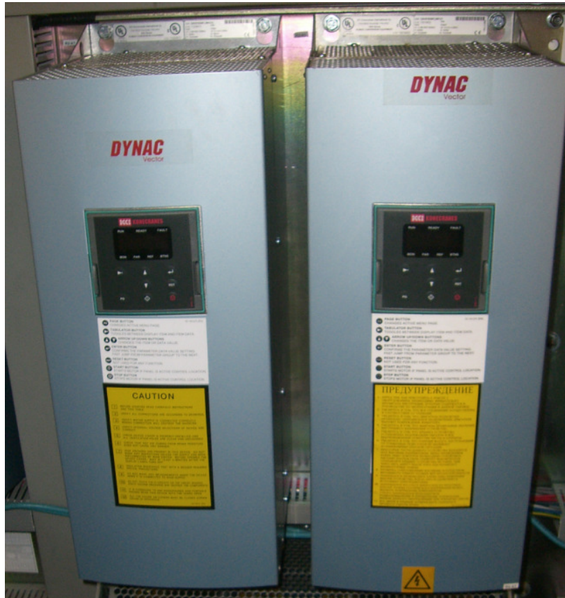
KUVA 9. 18,5 kilowatin DAV-taajuusmuuttajia (Merimaa, Joonas, 2010).
