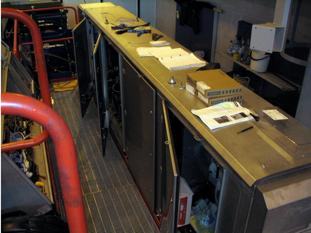
Kuva 9 EU 440 -sähkökaappi yläkehän vasemmalla puolella
