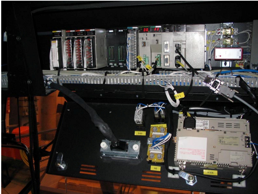
Kuva 15 Logiikka-yksiköt ohjaamon koteloon asennettuna
