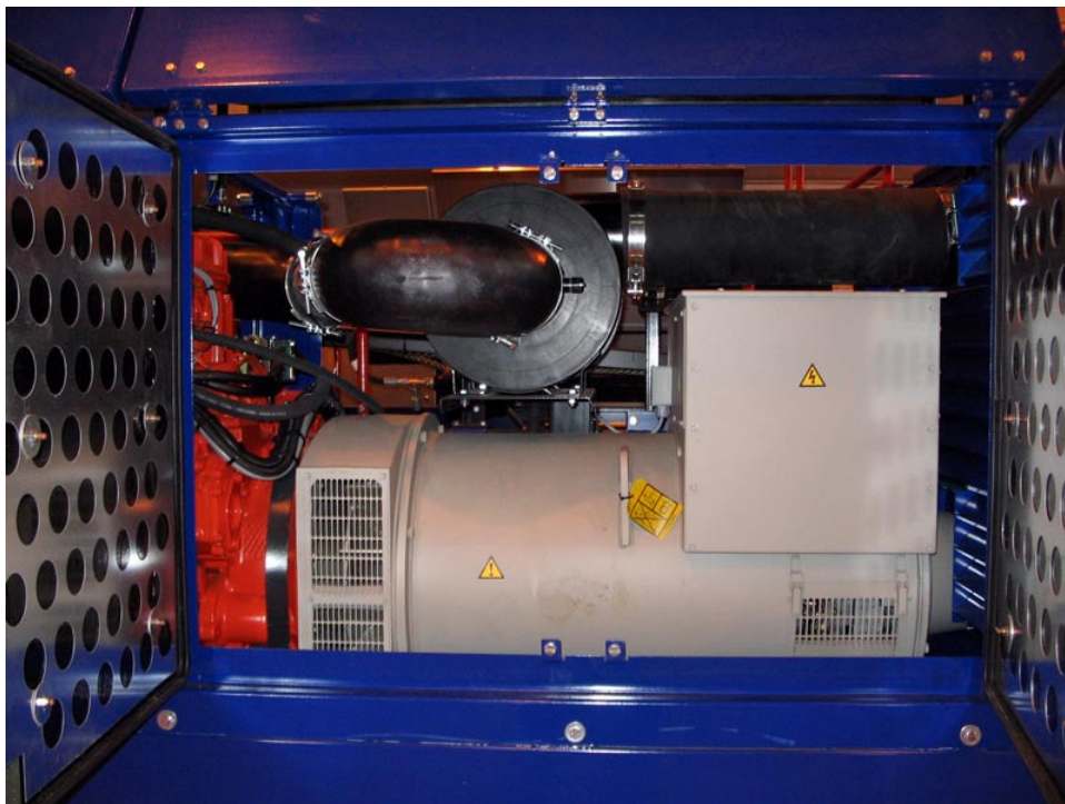
Kuva 8 Generaattori asennettuna moottorikehikossa
