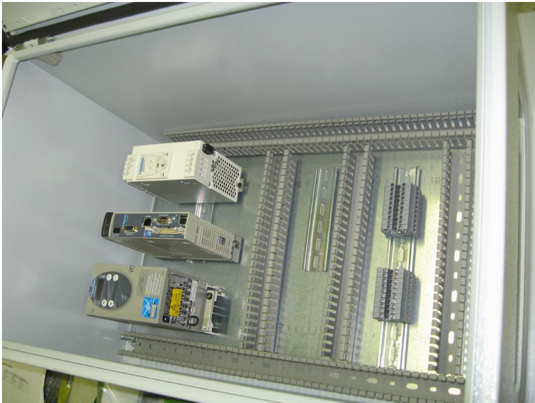
Kuva 1. Harjoitustyönä koottava Telemecaniquen yksiakselinen servojärjestelmän kesken oleva automaatioalakeskus.
