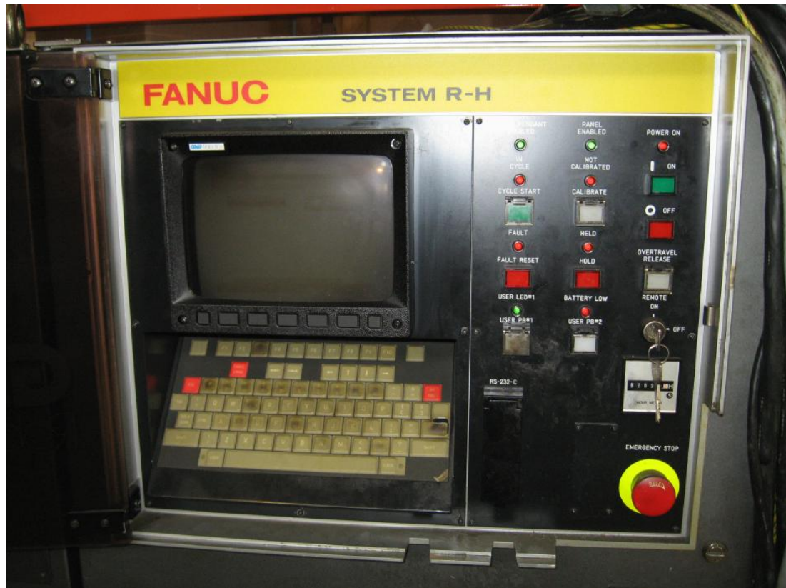
Kuva 4. Fanuc S-700 –robotin ohjausjärjestelmä.
