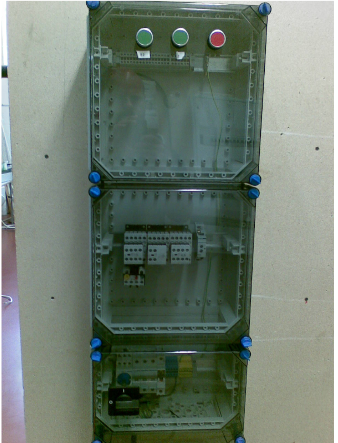
Kuva 4. Moottoriasennusharjoituksissa käytettävä ohjauskeskus
