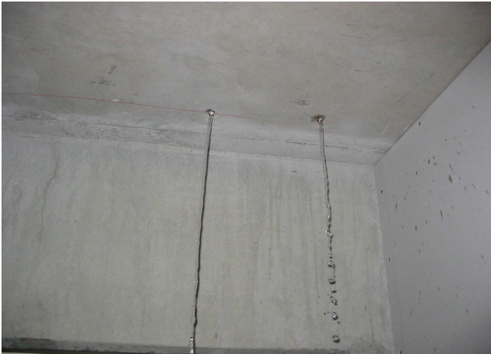
Kuva 19: Onteloihin jäänyt vesi valuu ulos poratuista reistä.
