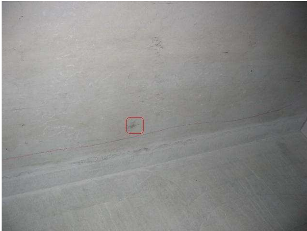
Kuva 15:Liidulla merkattu ontelo, jossa mahdollisesti kosteutta. Ympyröity alue oli kostea.
