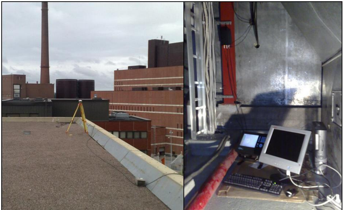
Kuvat 18 ja 19. Koko testilaitteisto Merenkululaitoksen katolla ja ilmastointihuoneessa. Vasemmassa kuvassa näkyvä antennikaapeli tulee sisälle oikean puoleisessa kuvassa ylhäällä keskellä näkyvästä reiästä sisälle.
