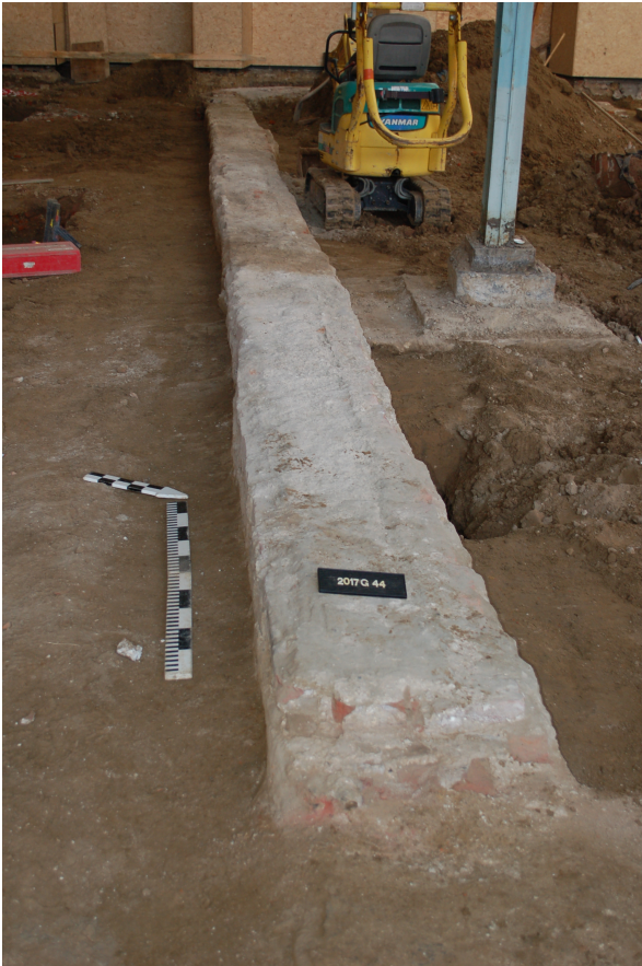
Figuur 27: De muurfundering spoor S1 vanuit het westen (©agentschap Onroerend Erfgoed: Geert Vynckier).
