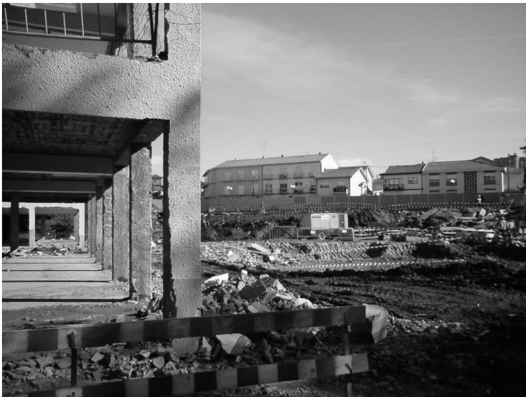
fig. 10_ Escola Secundária de Rio Tinto (arquiteto Rui Mealha 2008-2009) durante a intervenção. Representação fotográfica do processo de construção do novo edifício, juntamente com a reabilitação do existente.
