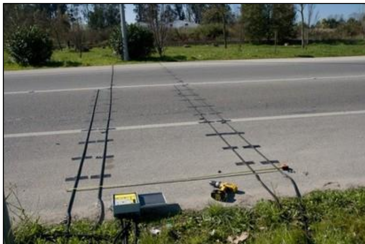
Figura 10. Esempio di installazione di tubi pneumatici.
