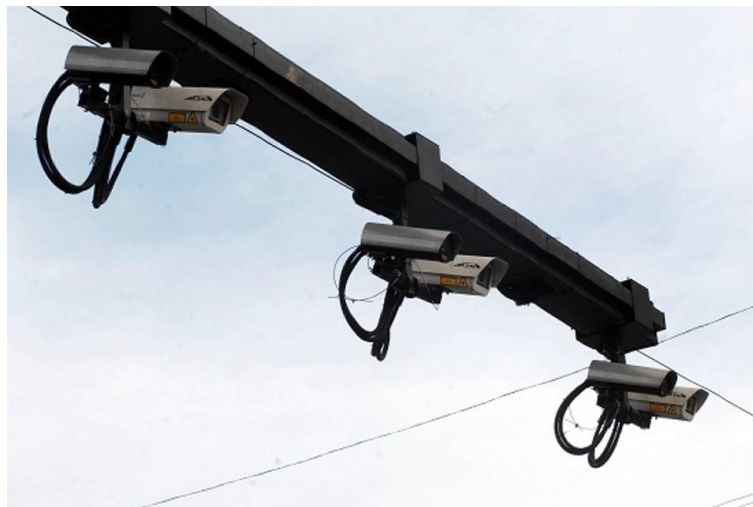
Figura 14. Esempio di installazione di telecamere per il monitoraggio del traffico.
