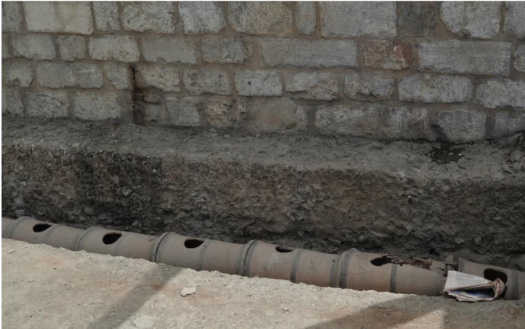
Fig. 11: Situación de deterioro actual del sistema de canalización de época de Pisistrates en la Plaza Sintagma. (Elaboración propia).
