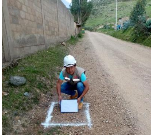
Foto N° 01: En la vista fotográfica se aprecia la ubicación de la calicata (C-01) en el margen izquierdo del tramo Puente Parco – Utcuyacu.
