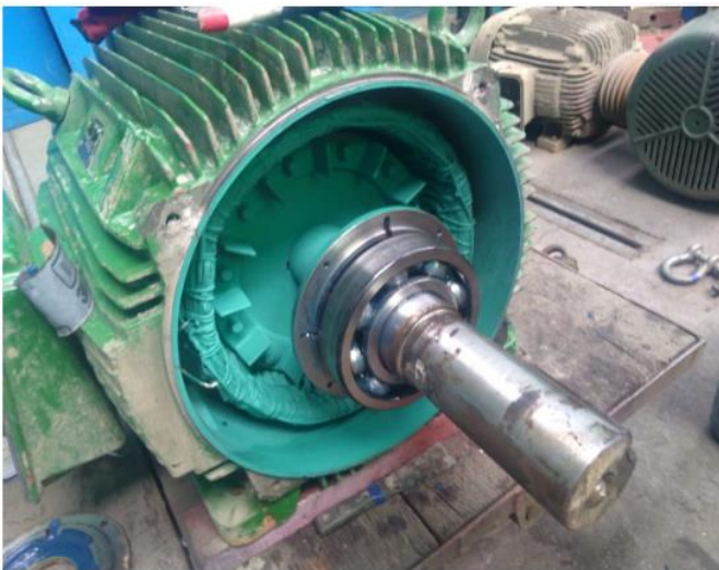
✓ Fallas de Motores y desalineamiento
