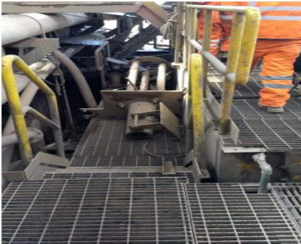
✓ Dificultad en el desmontaje de la Celda
