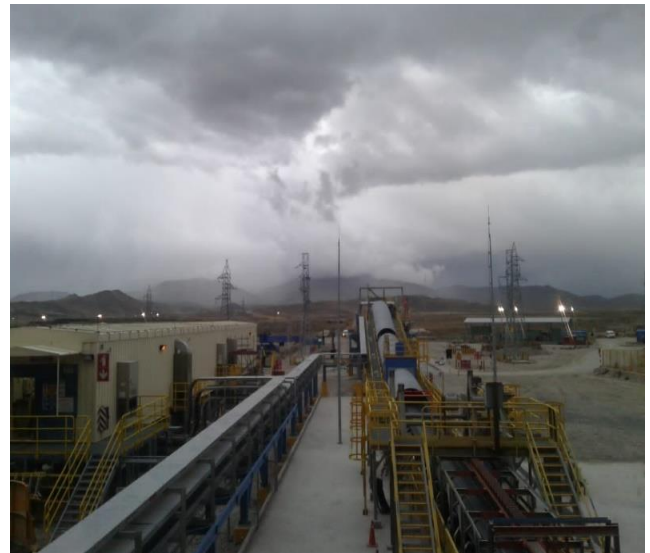
✓ Contratiempos debido a Tormentas Eléctricas
