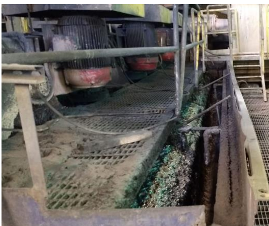
✓ Motores de Celda de Flotación
