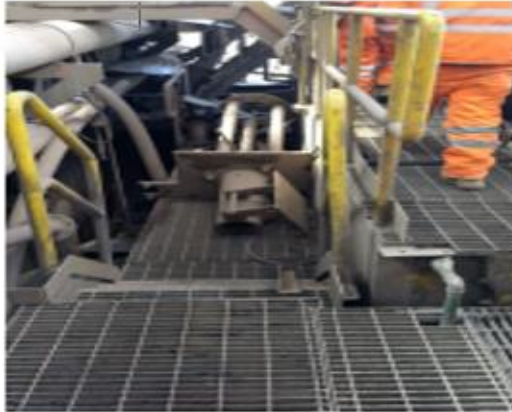
✓ Dificultad en el desmontaje de la Celda
