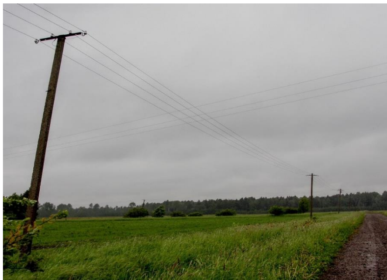
Joonis 2.2 Mastalajaama 7975 asukoht.
