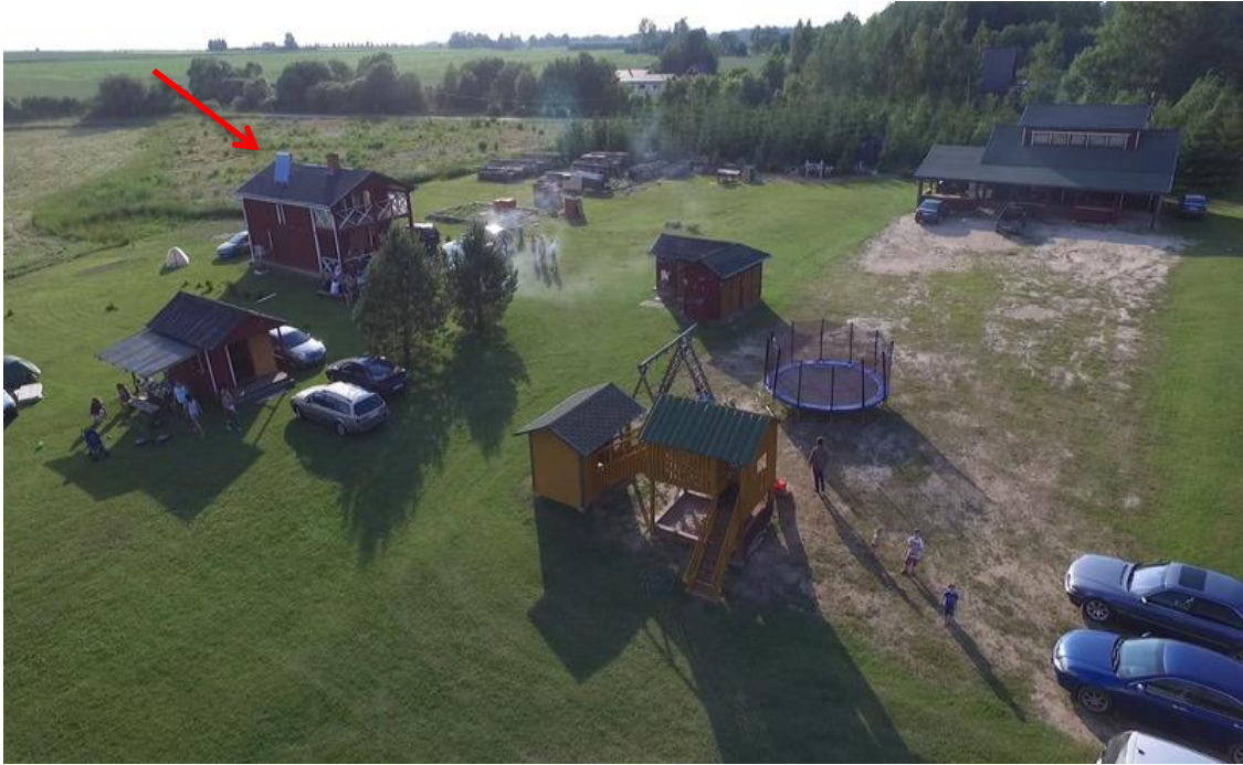
Joonis 2.5. Turismitalu peremaja hoone katusel paiknev vaakum torudega kollektor, punase noolega tähistatud [16]
