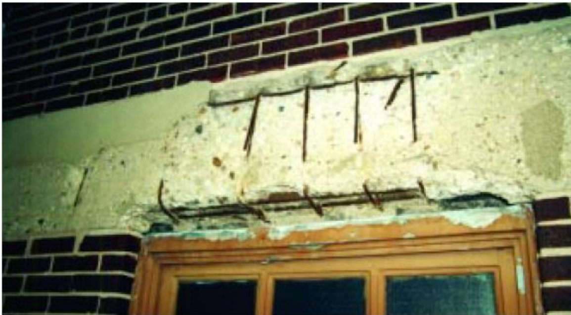
Joonis 1.4. Karboniseerumisest põhjustatud terassarruse korrosioon (PCA 2002).
