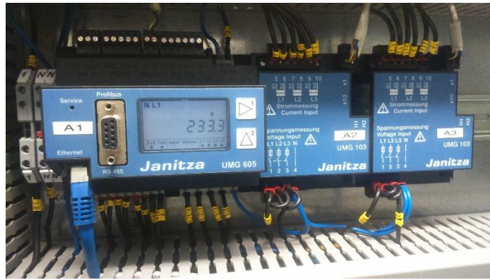
Joonis 3.15. Energiaanalüsaatorite paigaldus elektrikilbis
